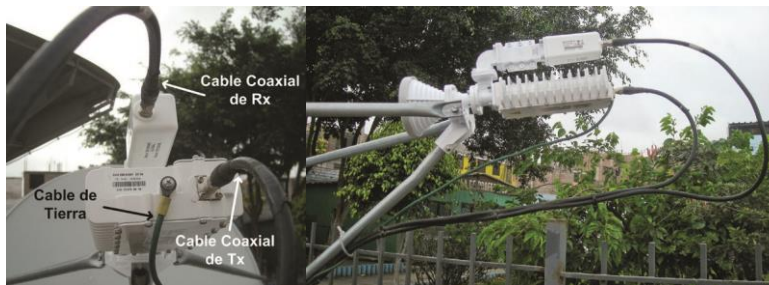
Figura 35. Conexión Cables ODU
