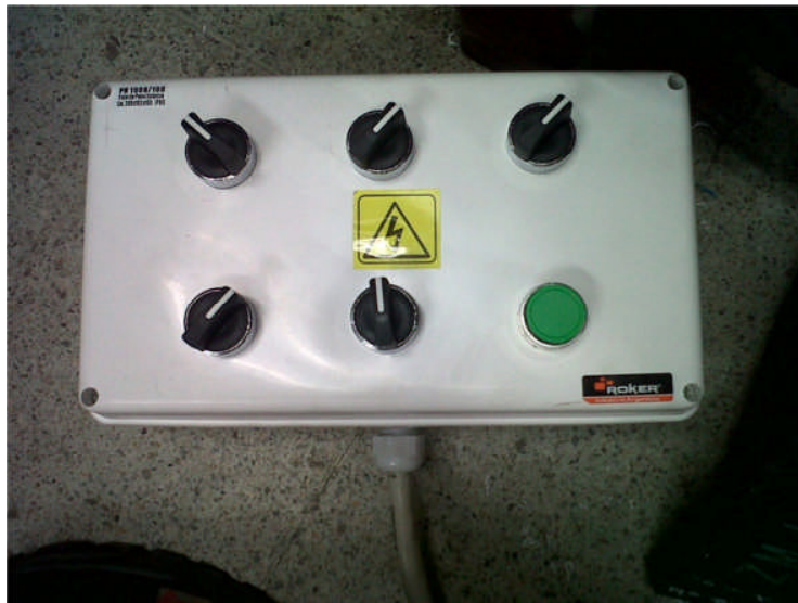
Figura 4: Tablero de mandos extra
