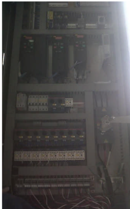
Figura 3: Tablero de control máquina Fongs
