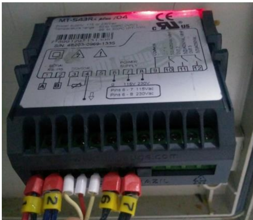
Ilustración 16. Conexión de controlador MT-543Ri plus de Full gauge
