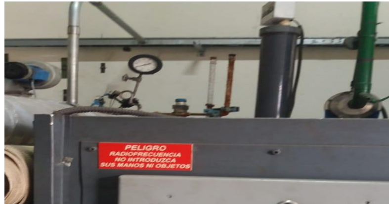
Figura 13. Señalizaciones encontradas secador por radiofrecuencia Stalam. Fuente: autoras
