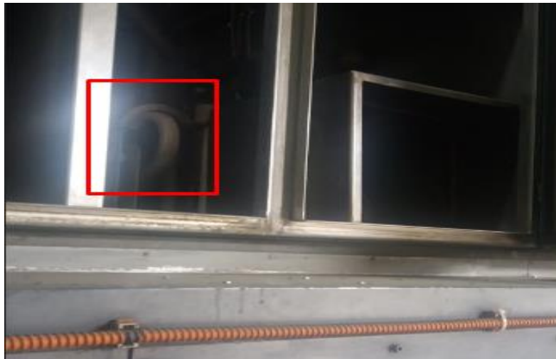
Figura 11. Vista interna secador por radiofrecuencia Stalam. Fuente: autoras
