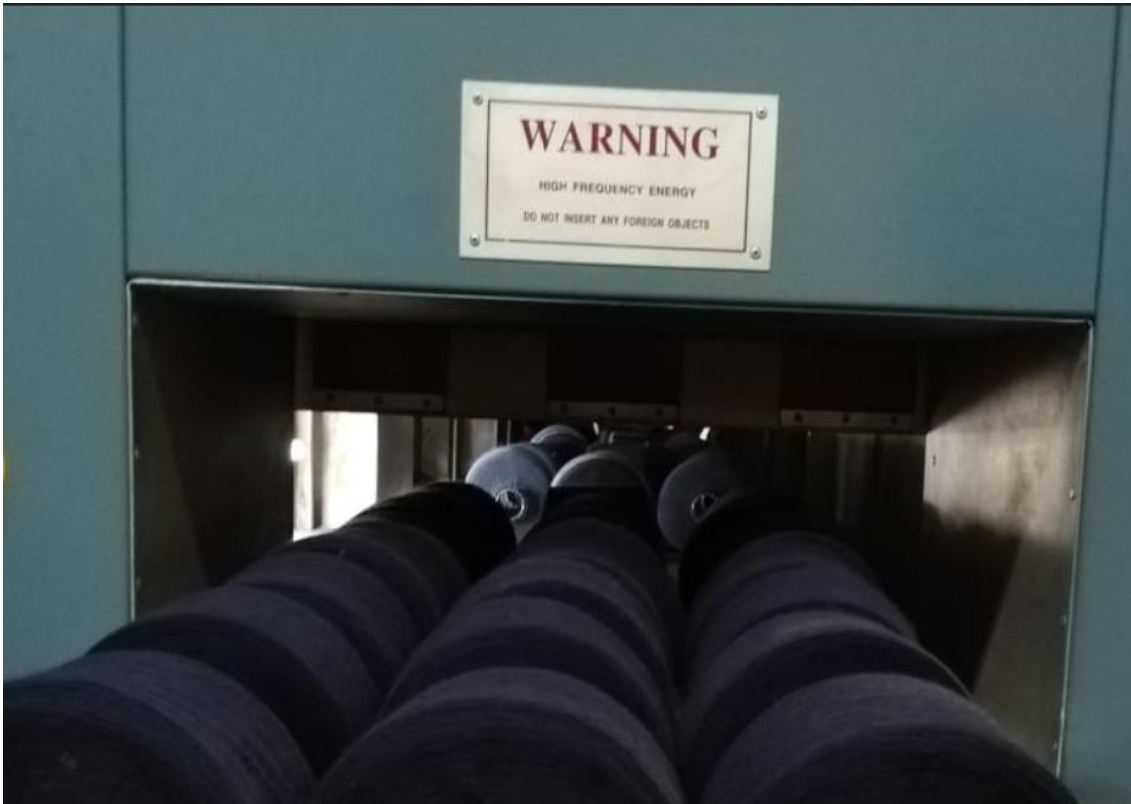
Figura 16. Señalizaciones encontradas secador por radiofrecuencia Strayfield. Fuente: autoras
