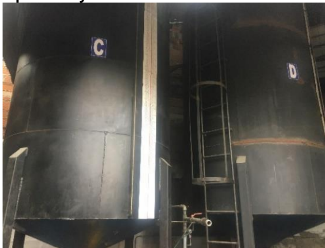
Foto 6. Tanque de despacho C y D
