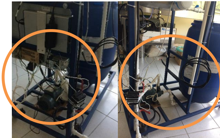
Figura 37: Cableado expuesto Planta piloto
