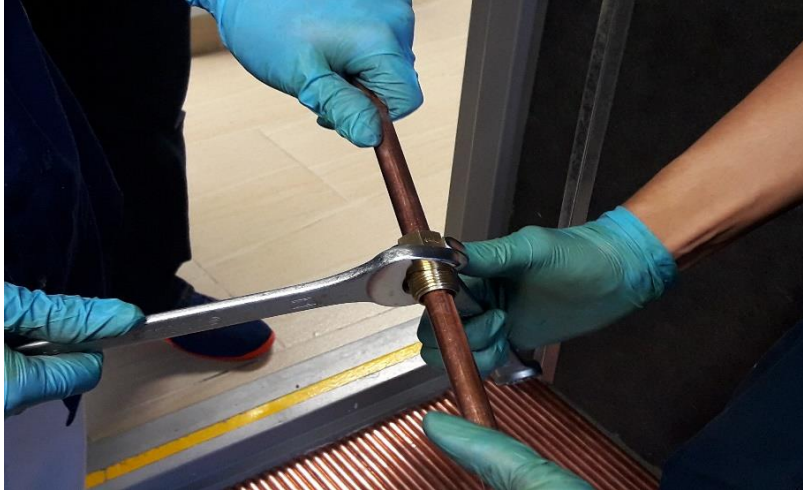
Fig. 27. Unión de racores con llave boca fija. Fuente: Elaboración propia.
