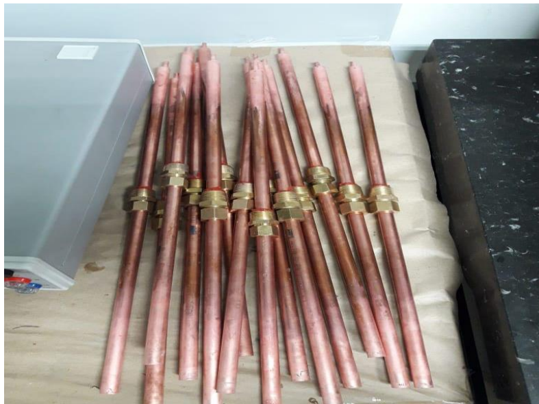
Fig. 33. Oxido y hollín removido. Fuente: Elaboración propia.
