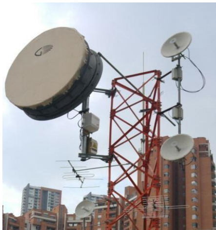
Figura 26. Antena Instalada y Apuntada.
