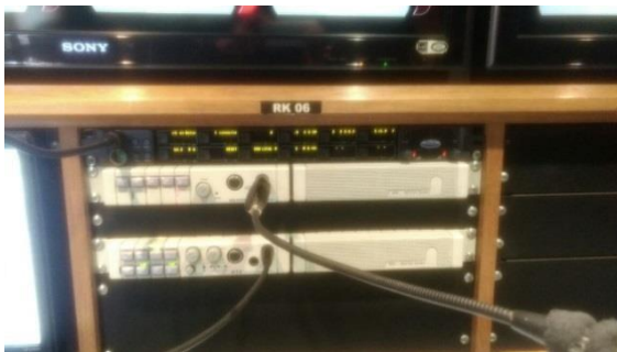
Figura 30. Panel Clear-Com Instalado en Estacion Móvil de Transmision.
