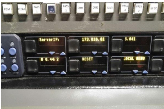
Figura 23: Apreciación de Parámetros IP Estáticos en Panel Clear-Com del Máster de Transmisión.
