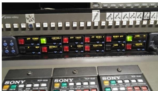
Figura 19. Panel Clear-Com Ubicado en la Consola del Máster de Transmisión.
