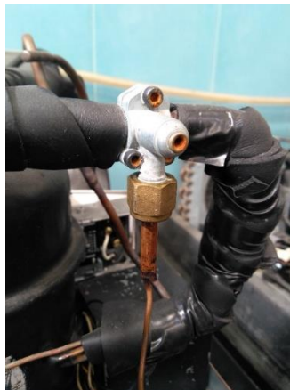
Figura 21. Válvula Pinchatubo instalada en la tubería
