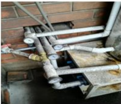
Tubería y presostatos de fluido(agua)
