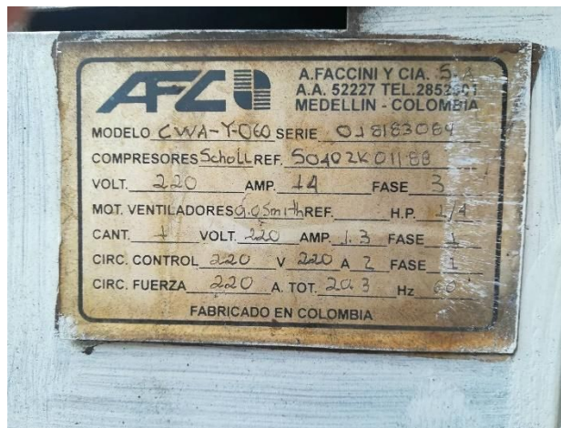
Figura 9. Fotografía Placa con datos nominales chiller #1
