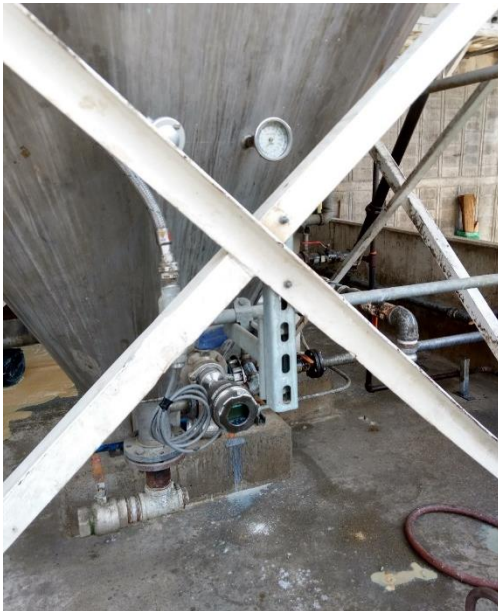
Ilustración 45. Tanque 31 en condiciones actuales, con su respectiva instrumentación para el sensado del nivel y la temperatura, fotografía del autor.
