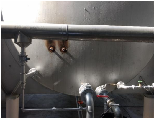
Ilustración 57. Condiciones en el mes de noviembre del tanque 05, fotografía del autor.
