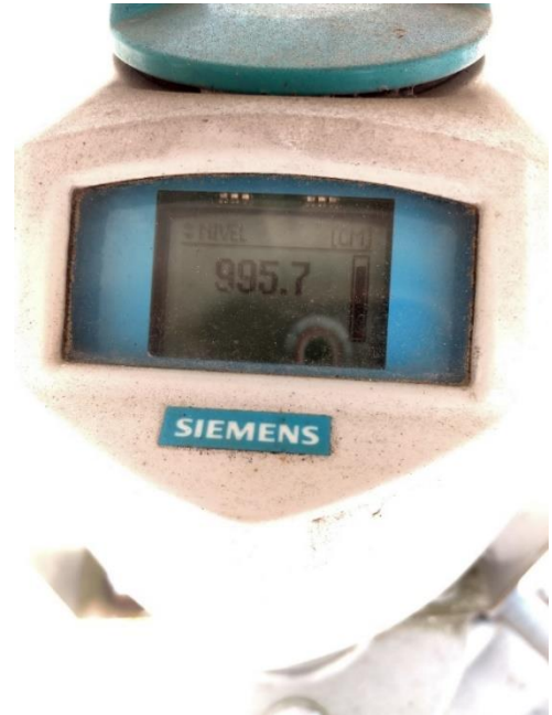
Ilustración 31. Medición de nivel en tanque contenedor de sebo, fotografía del autor.
