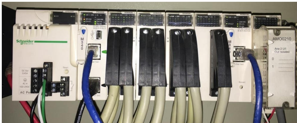
Ilustración 26. PLC M340, controlador del proceso, fotografía del autor.
