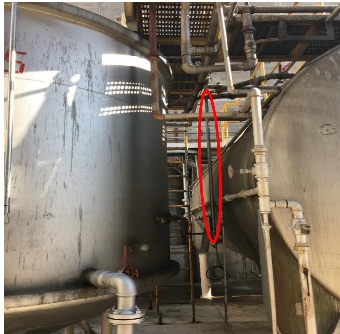
Ilustración 42. Condiciones actuales del tanque de mezclas con implementación de tubería IMC y cable encauchetado para electroválvulas, fotografía del autor.
