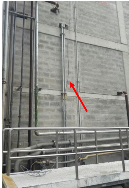
Ilustración 69. Cables Ethernet implementados, fotografía del autor.
