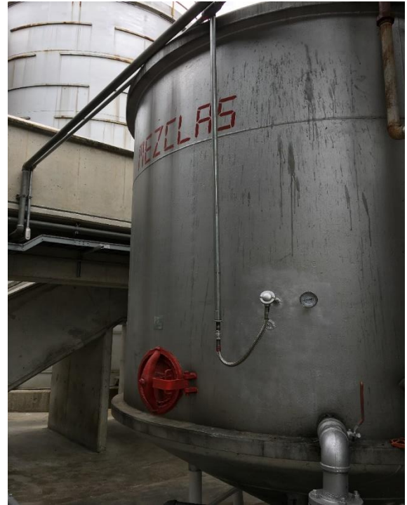
Ilustración 41. Condiciones actuales del tanque de mezclas con implementación de Pt-100, fotografía del autor.
