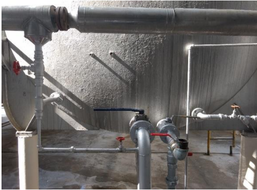
Ilustración 63. Condiciones en el mes de noviembre del tanque 08, fotografía del autor.
