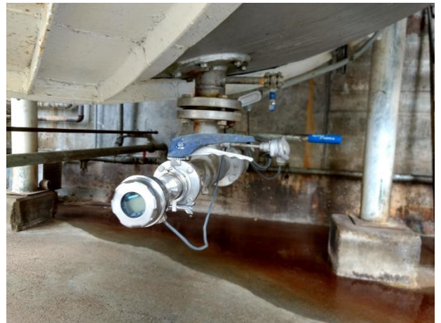
Ilustración 46. Condiciones actuales del tanque 33 para el respectivo sensado del nivel y la temperatura, fotografía del autor.
