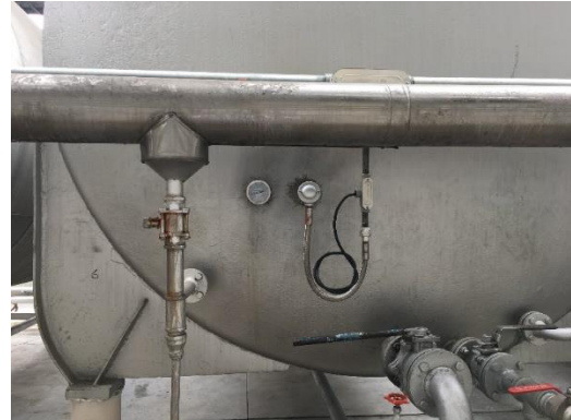
Ilustración 60. Condiciones actuales del tanque 06, con implementación de la instrumentación, fotografía del autor.
