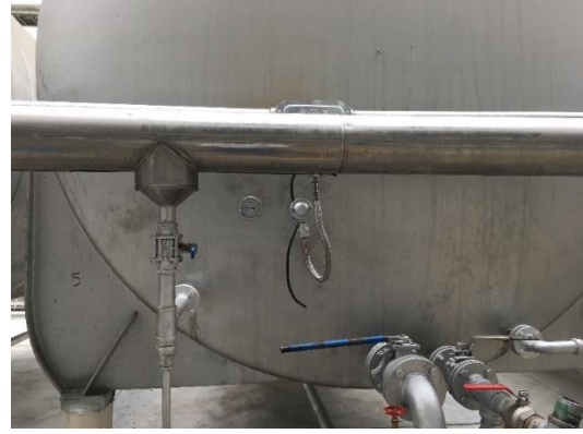
Ilustración 58. Condiciones actuales del tanque 05, con implementación de la instrumentación, fotografía del autor.
