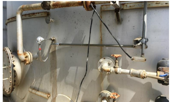
Ilustración 39. Condiciones actuales del sensado de temperatura del tanque 4, fotografía del autor.
