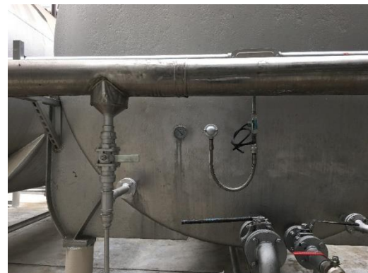
Ilustración 62. Condiciones actuales del tanque 07, con implementación de la instrumentación, fotografía del autor.
