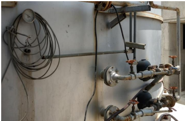
Ilustración 38. Condiciones iniciales del sensado de temperatura del tanque 4, fotografía del autor.
