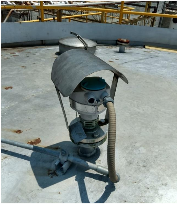
Ilustración 30. Sensor LR250 implementado en los cuatro tanques, fotografía del autor.
