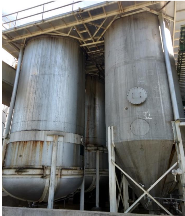
Ilustración 10. Tanques verticales, fotografía del autor.
