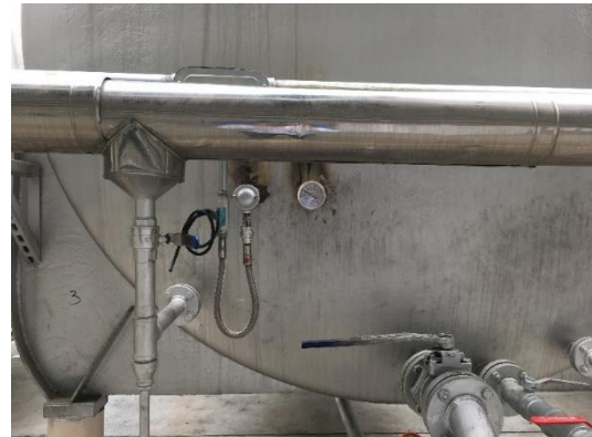
Ilustración 54. Condiciones actuales del tanque 03, con implementación de la instrumentación, fotografía del autor.
