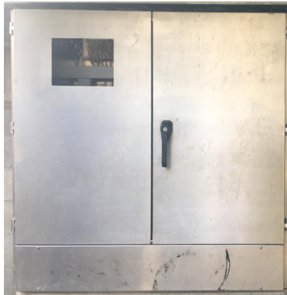
Ilustración 4. Gabinete de elementos eléctricos de protección, comunicación y control, fotografía del autor.
