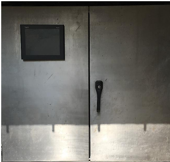
Ilustración 28. HMI implementada en gabinete eléctrico, fotografía del autor.
