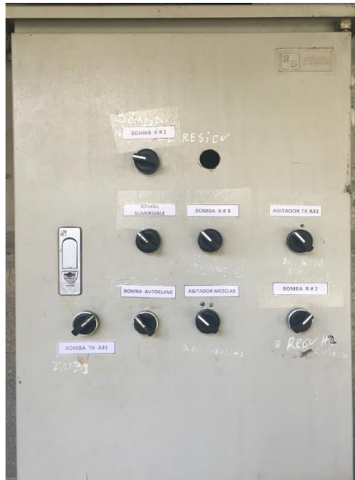
Ilustración 3. Gabinete de accionamiento de bombas y agitadores, fotografía del autor.
