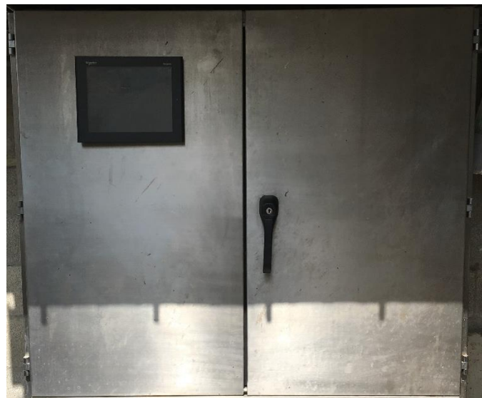
Ilustración 66. Gabinete con implementación de HMI Magelis, fotografía del autor.
