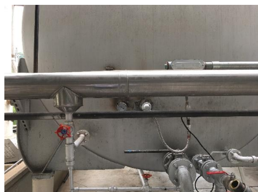
Ilustración 50. Condiciones actuales del tanque 01, con implementación de la instrumentación, fotografía del autor.
