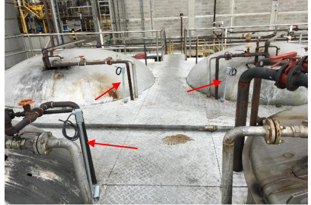
Ilustración 44. Condiciones actuales de los tanques verticales con implementación de tubería IMC y cableado encauchetado para electroválvulas, fotografía del autor.
