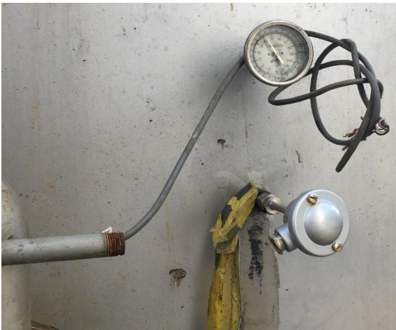
Ilustración 32. Condiciones iniciales para el sensado de temperatura en el tanque 1, fotografía del autor.
