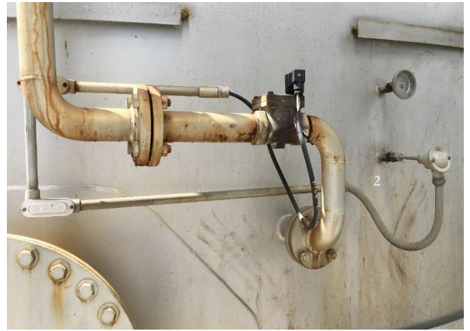
Ilustración 35. Condiciones actuales del tanque 2, fotografía del autor.
