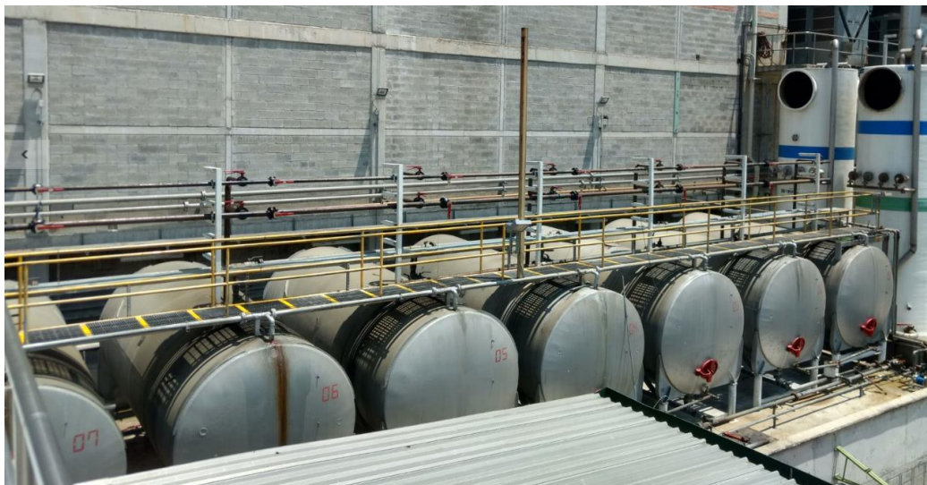
Ilustración 11. Tanques horizontales de almacenamiento y despacho de sebo y aceite, fotografía del autor.
