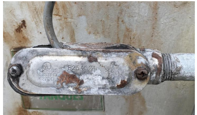
Ilustración 33. Conduleta para el cableado del sensor del tanque 1, fotografía del autor.
