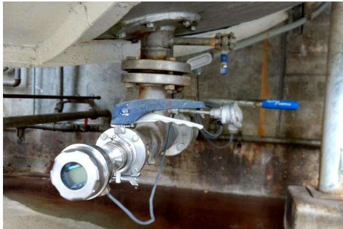
Ilustración 19. Transmisor de nivel SITRANS P300, fotografía del autor.
