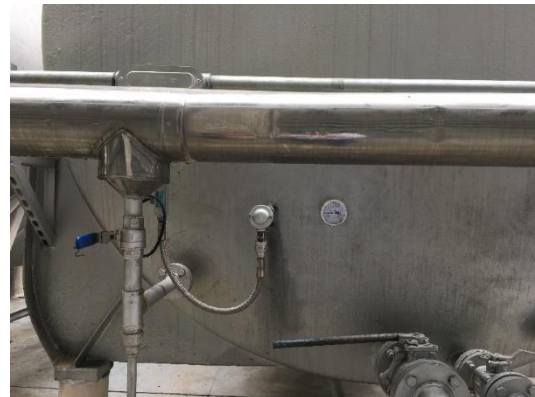
Ilustración 52. Condiciones actuales del tanque 02, con implementación de la instrumentación, fotografía del autor.
