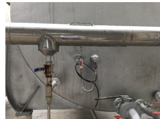
Ilustración 56. Condiciones actuales del tanque 04, con implementación de la instrumentación, fotografía del autor.
