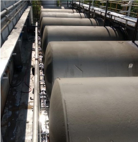
Ilustración 47. Condiciones iniciales de tanques horizontales sin cableado para sensores ni electroválvulas, fotografía del autor.
