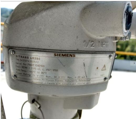
Ilustración 17. Datos técnicos de sensor de nivel Sitrans, fotografía del autor.
