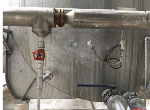
Ilustración 64. Condiciones actuales del tanque 08, con implementación de la instrumentación, fotografía del autor.
