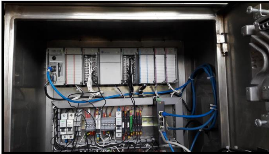
Figura 10. PLC ubicado en gabinete de control. Fuente: Propia (Zapata, 2016)
