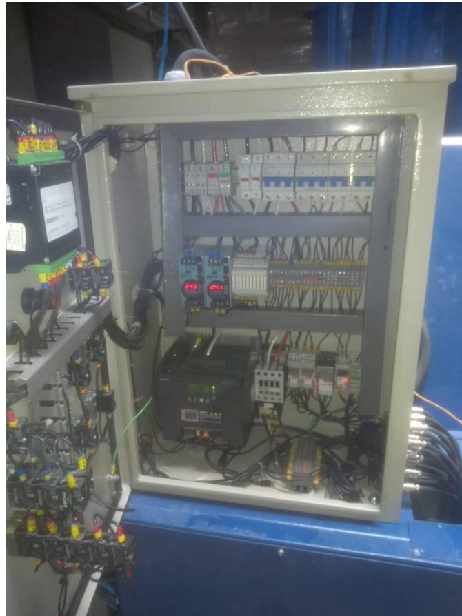
Figura 40. Tablero cableado en su totalidad. En la parte inferior derecha es posible observar los conectores donde se cablean los sensores y actuadores del sistema.
