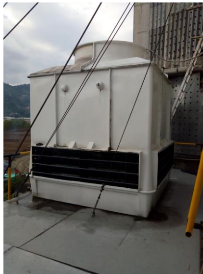
Figura 13. Torre de enfriamiento 1.
