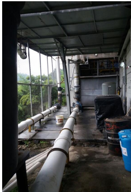
Figura 16. Ducto de alimentación.
