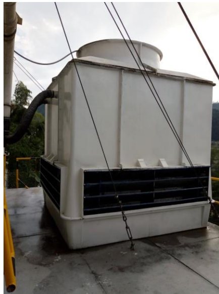
Figura 14. Torre de enfriamiento 2.
