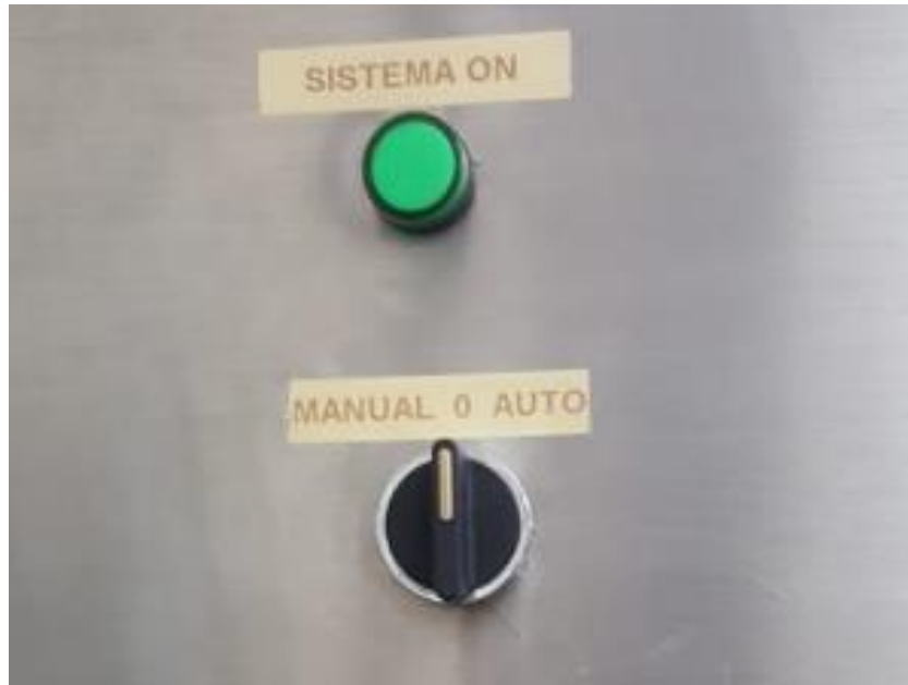
Figura 12. Indicador de encendido e interruptor de control de tres posiciones.
