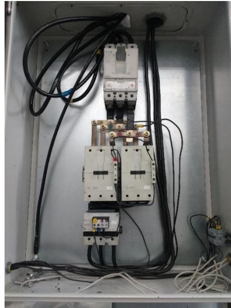
Figura 15. Gabinete de potencia.
