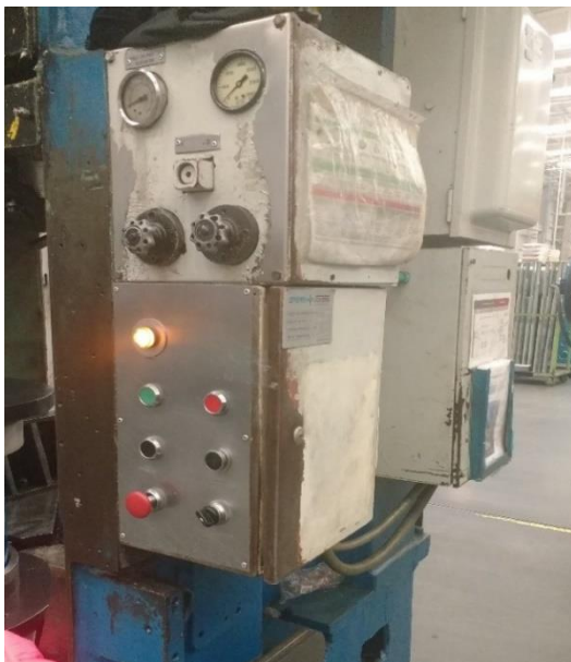
Figura 10. Gabinete de control y válvulas reguladoras de presión.
