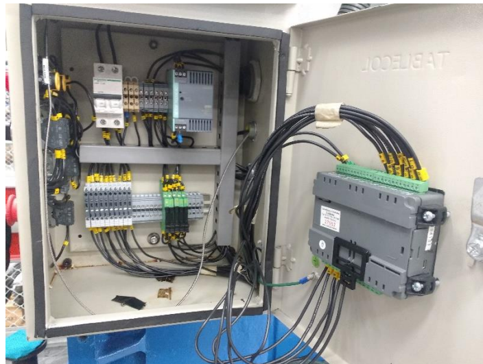
Figura 18. Interior del gabinete de control
