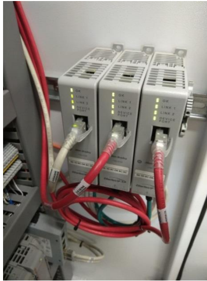
Figura 15. Swiches repetidores (Imagen propia autoría, tomada después del montaje de tableriar el control, CIA Noel, Medellín 2017)
