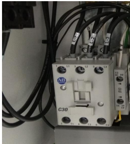
Figura 8. Contactor eléctrico de la máquina Formost Alpha II.
