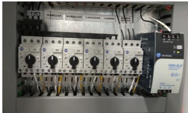
Figura 16. Guardamotores (Imagen propia autoría, tomada después del montaje de tableriar el control, CIA Noel, Medellín 2017)
