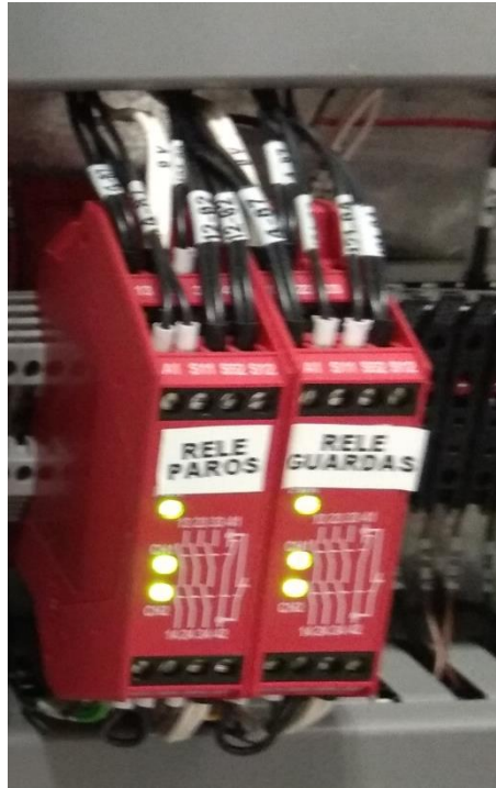
Figura 11. Relés de seguridad (Imagen propia autoría, tomada después del montaje de tableriar el control, CIA Noel, Medellín 2017)
