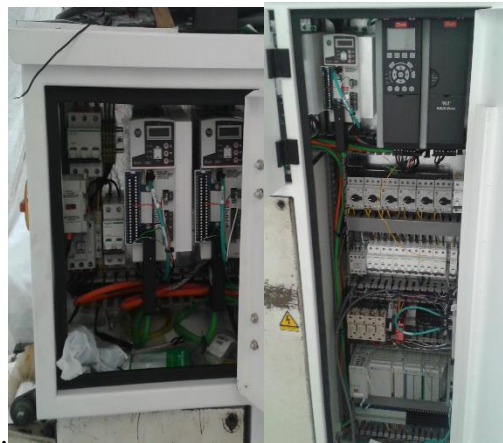
Foto 4: Elementos de potencia y control de vanguardia, cableado nuevo peinado (Imagen propia autoría, tomada después de la actualización, CIA Noel, Medellín 2017)
