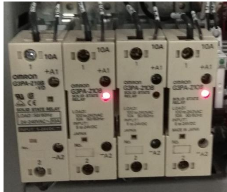
Figura 10. Relé de estado sólido del control (Imagen propia autoría, tomada después del montaje de tableriar el control, CIA Noel, Medellín 2017)
