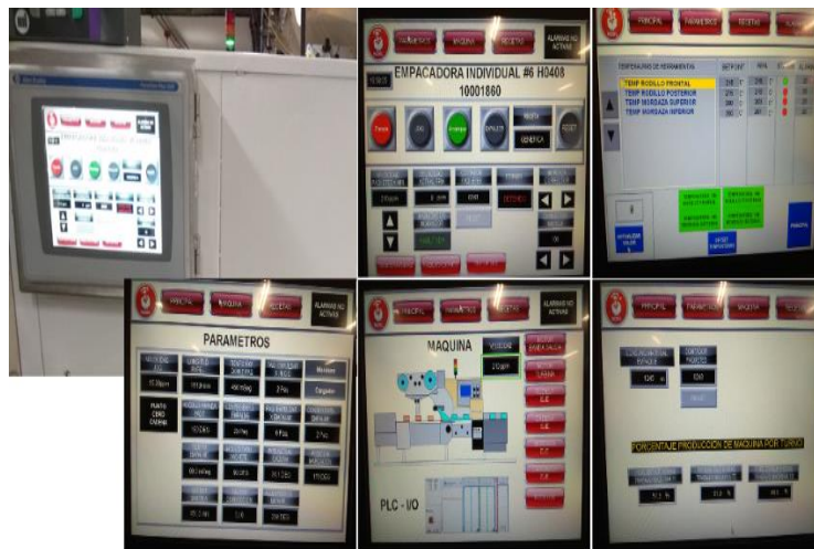
Foto 6: Pantalla táctil habilitada para: Operación, Monitoreo, Parametrización y Recetas (Imagen propia autoría, tomada después de la actualización, CIA Noel, Medellín 2017)
