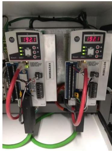
Figura 12. Servo drive (Imagen propia autoría, tomada después del montaje de tableriar el control, CIA Noel, Medellín 2017)
