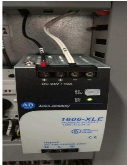
Figura 14. Fuente de voltaje (Imagen propia autoría, tomada después del montaje de tableriar el control, CIA Noel, Medellín 2017)
