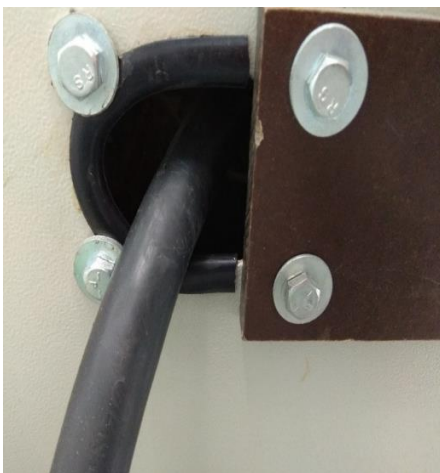
Figura 15. Cable de alta tensión apoyado en pestaña de caucho para protección de su recubrimiento aislantes. Autor.
