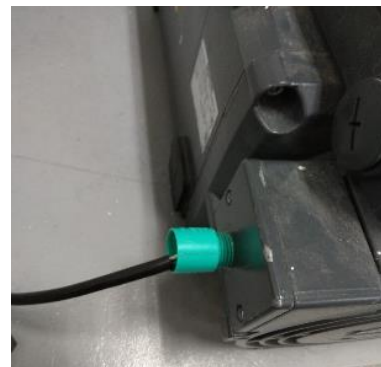
Figura 7. Instalación inadecuada de cable alimentación moto ventilador. Autor.
