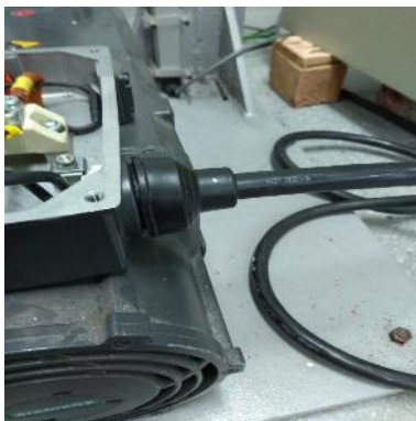
Figura 6. Mala instalación de cable alta tensión de motor eléctrico. Autor.
