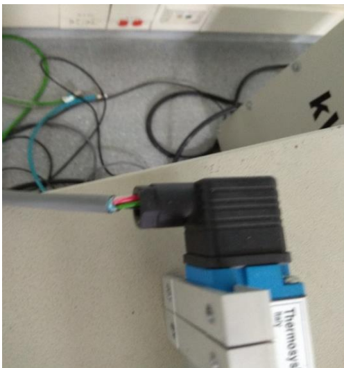
Figura 10. Cable en alto riesgo de sensor lineal. Autor.
