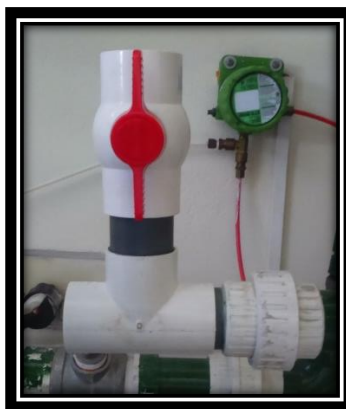
Figura 52 Montaje válvula 2 y T
