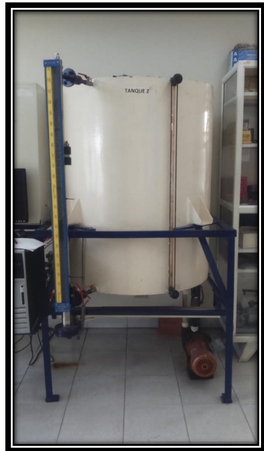
Figura 18 Tanque 2 y bomba
