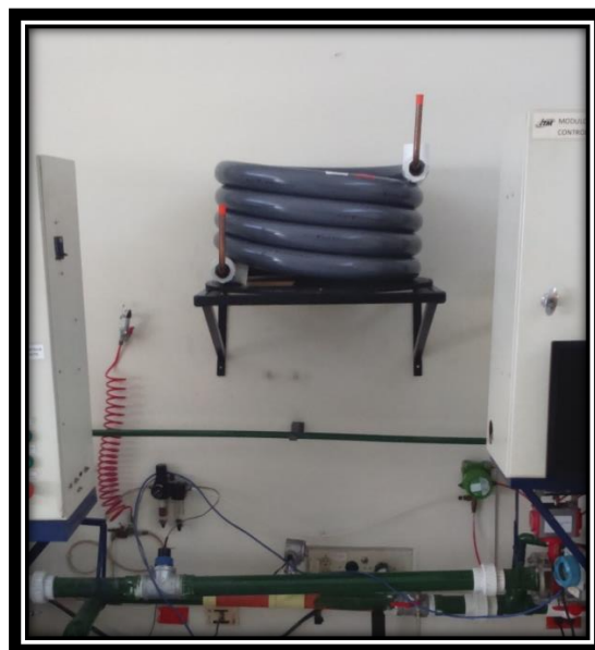
Figura 47 Montaje intercambiador en repisa
