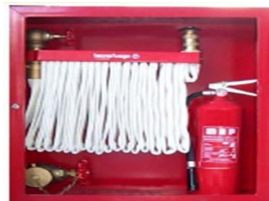
Figura 14. Gabinete de mangueras clase III.
