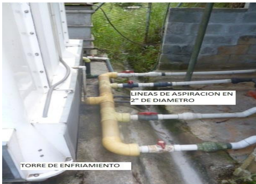
Figura 73. Cuarto de bombas Postelectras. Fuente: (Elaboración propia).
