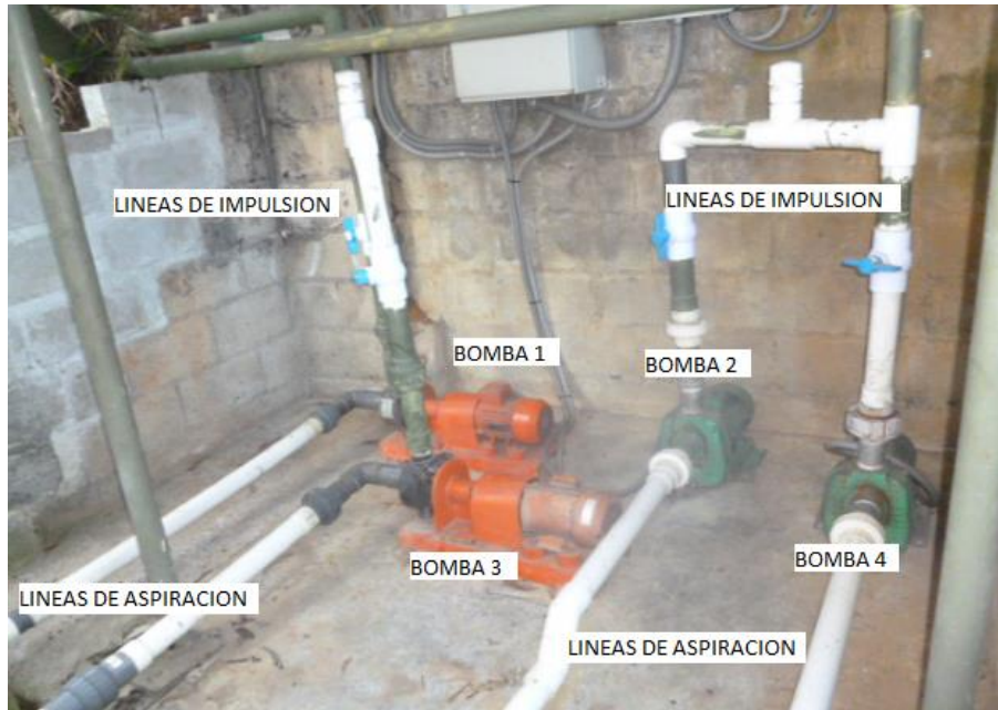
Figura 72. Cuarto de bombas Postelectras. Fuente: (Elaboración propia)
