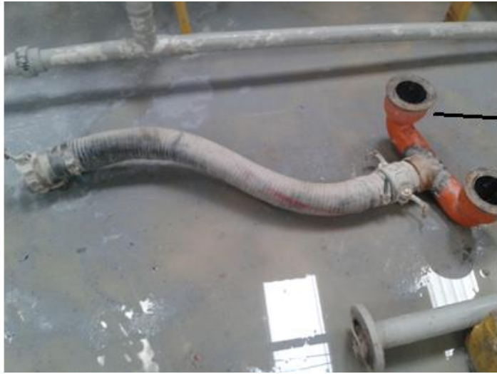
Figura 66: Múltiple de Descarga
