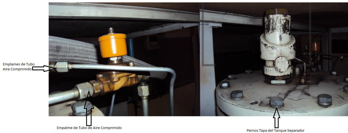
Figura 52: Pernos y Empalmes de Tubería de la Tapa del Tanque Separador
