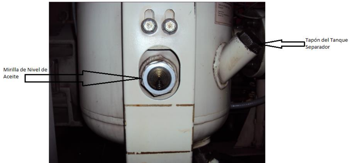
Figura 49: Tapón y Mirilla de Aceite en Tanque Separador
