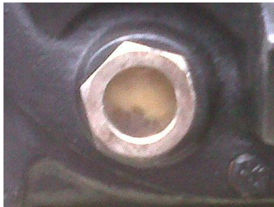
Figura 42: Condensación en Unidad Compresora
