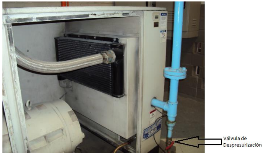
Figura 48: Válvula de Despresurización
