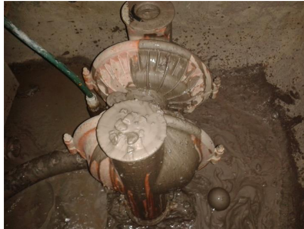
Figura 80: Mal procedimiento en Desensamble de Bomba de Doble Diafragma
