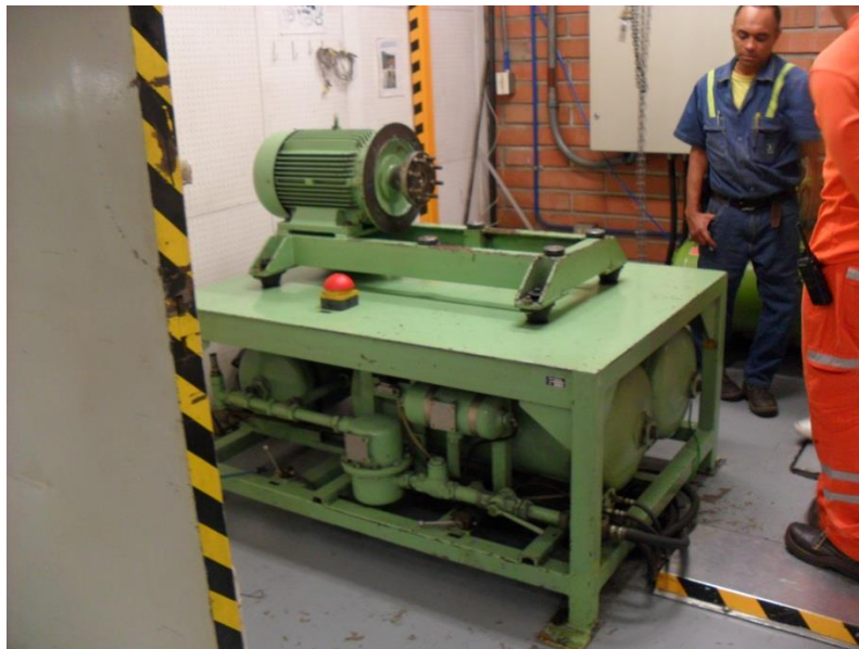
Banco de pruebas para unidades reparadas
