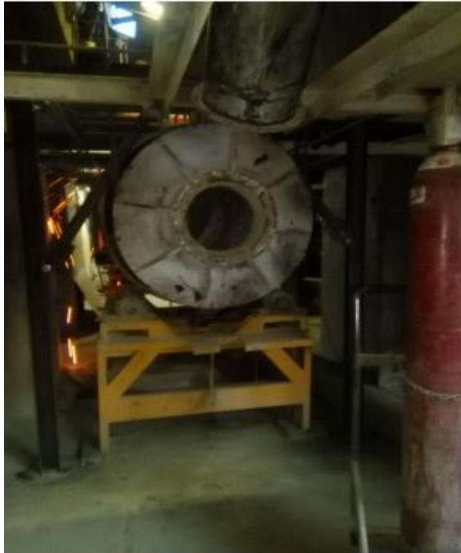
Figura 7. Horno de calcinación (Imagen suministrada por industrias EMU S.A)
