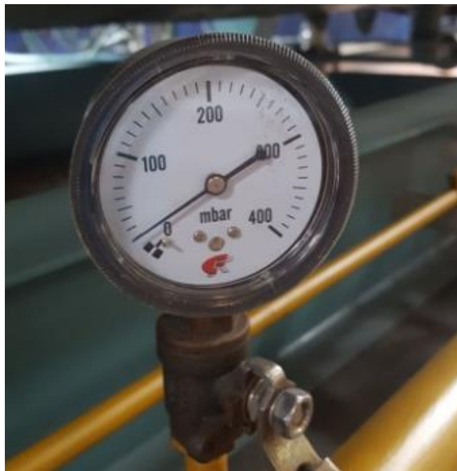
Figura 22. Manómetro de la presión del gas que le entra constantemente a la caldera. (Fuente: Autores)
