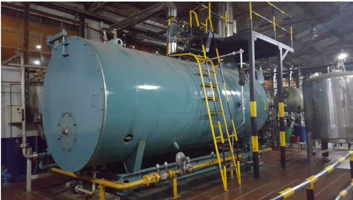
Figura 1. Aspecto de la caldera pirotubular Postobón S.A. Sede Guayabal (Fuente: autores)
