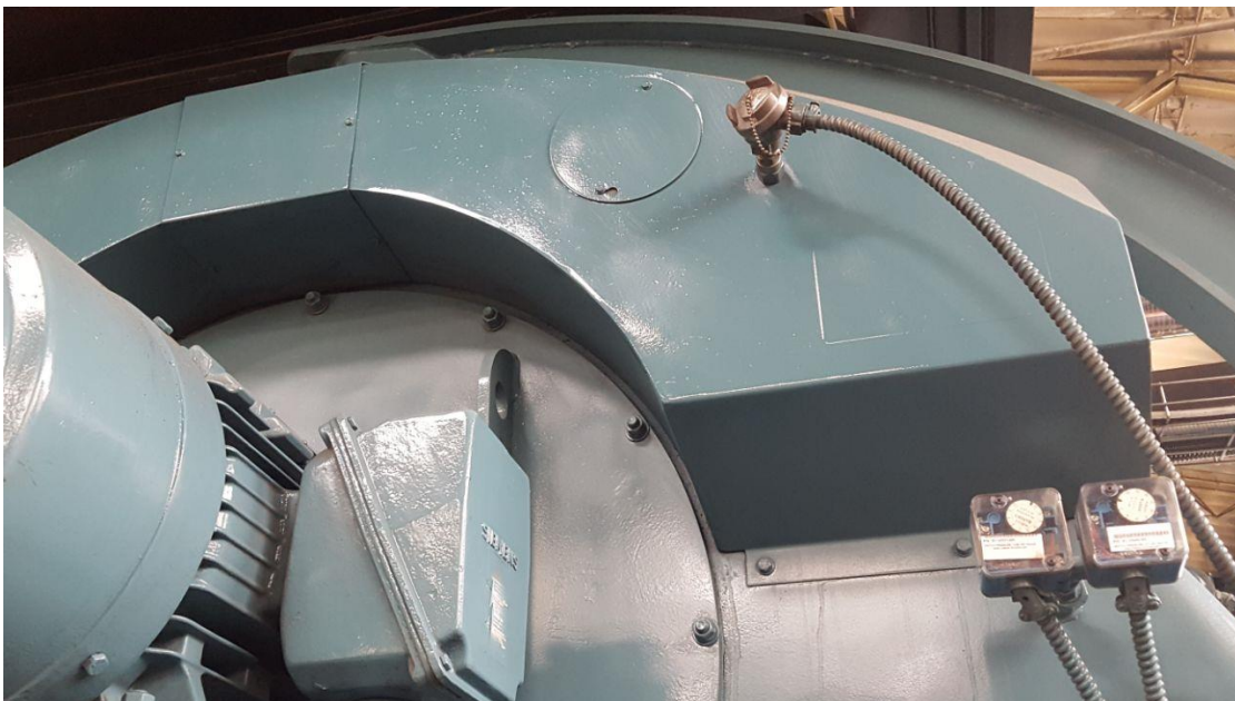
Figura 5. Aspecto del termostato de la caldera piro tubular Postobón S.A. Sede Guayabal (Fuente: autores)
