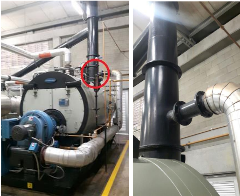
Figura 11. Aspecto Dámper distribuidor mariposa caldera Hospital Pablo Tobón Uribe (Fuente: Autores)
