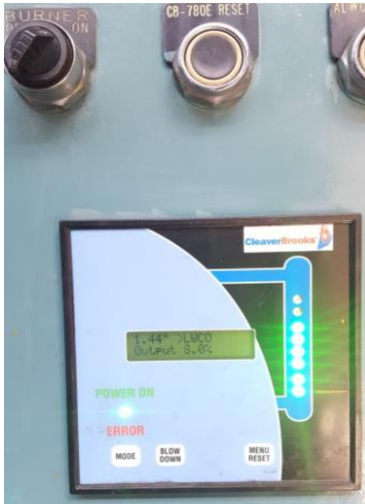
Figura 2. Aspecto control de nivel de agua de la caldera piro-tubular Postobón S.A. Sede Guayabal (Fuente: autores)
