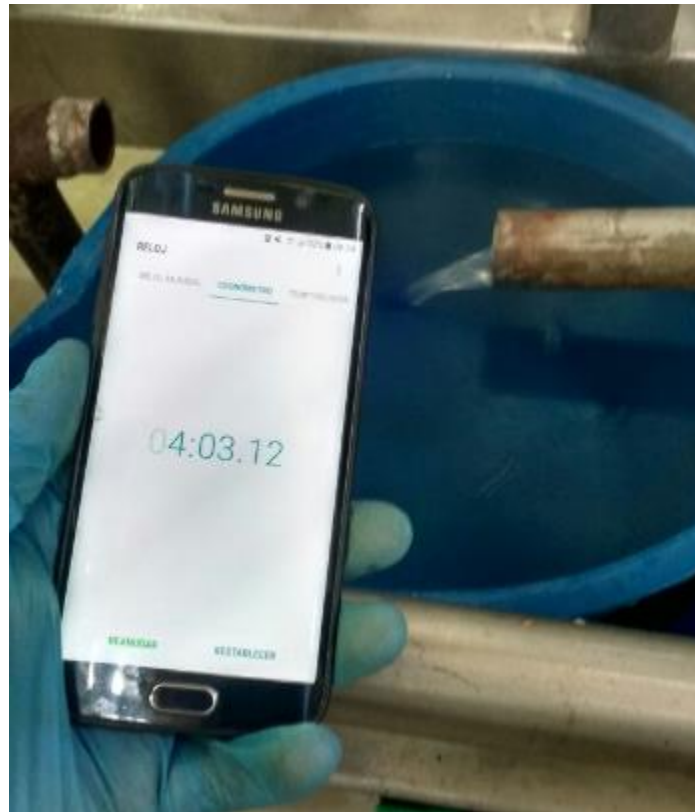
Figura 49. Medición del desperdicio de condensado en el sistema doypack (Fuente: autores)
