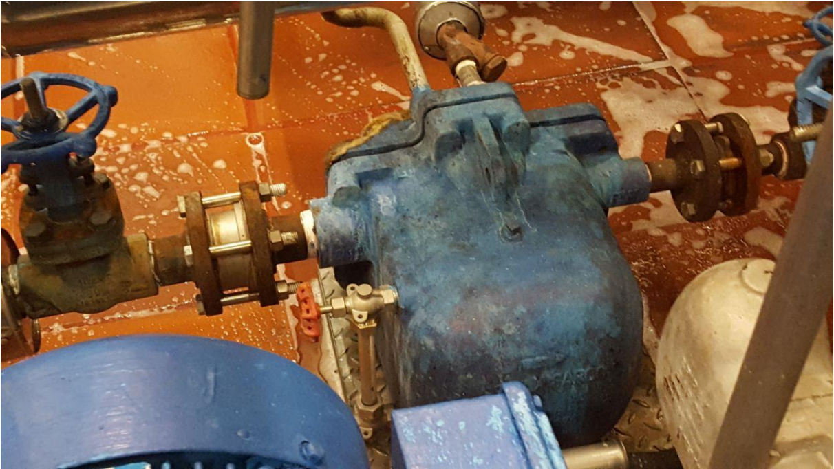
Figura 47. Mecanismo de bombeo del condensado del sistema del ultra-pasteurizador (Fuente: autores)
