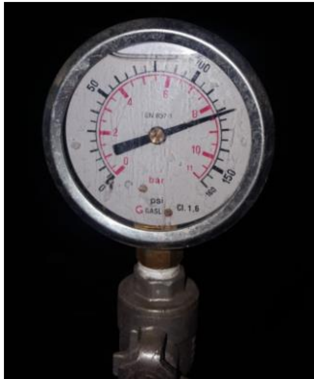
Figura 21. Manómetro de la presión del agua a la entrada de la caldera. (Fuente: Autores)
