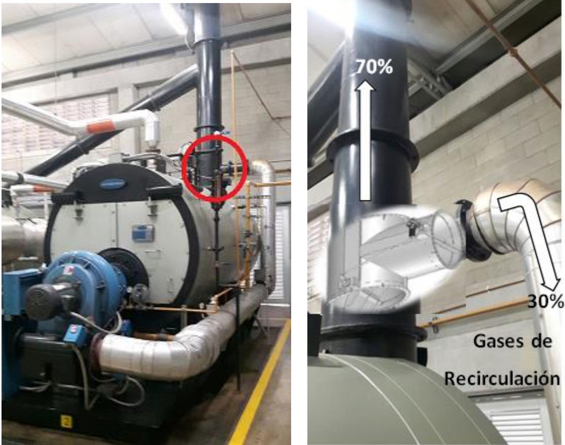
Figura 44. Demostración de la recirculación de los gases (Fuente: autores)
