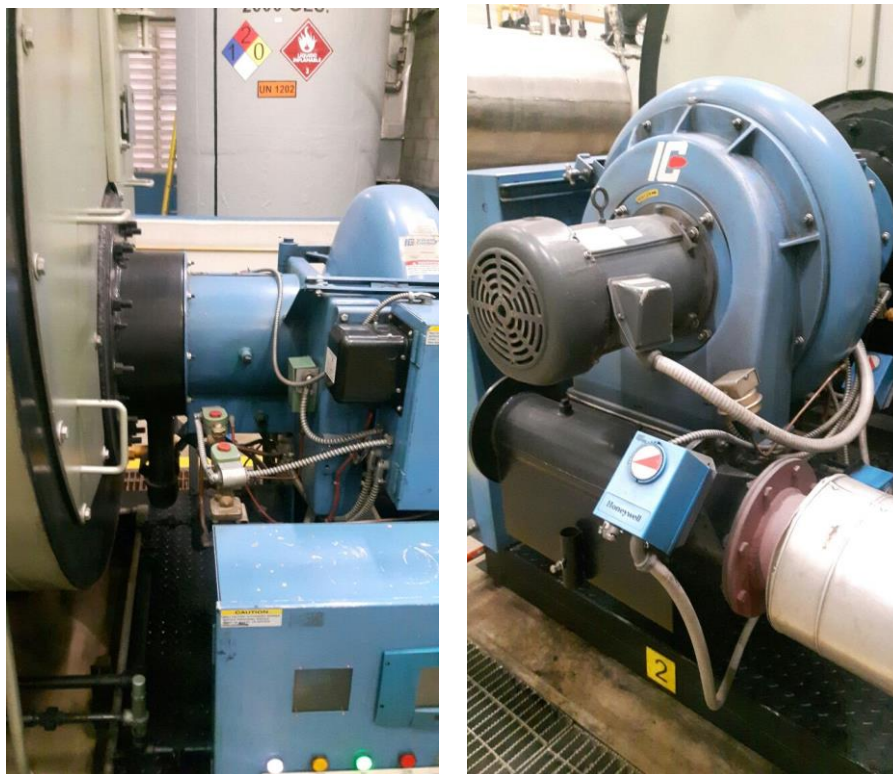
Figura 3. Aspecto del quemador y ventilador de caldera pirotubular del Hospital Pablo Tobón Uribe (Fuente: autores)
