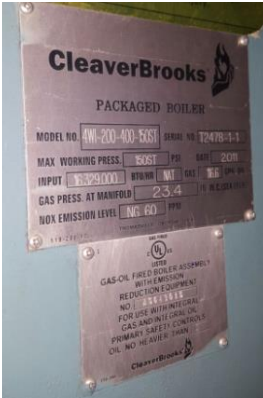
Figura A1. Placa de la caldera
