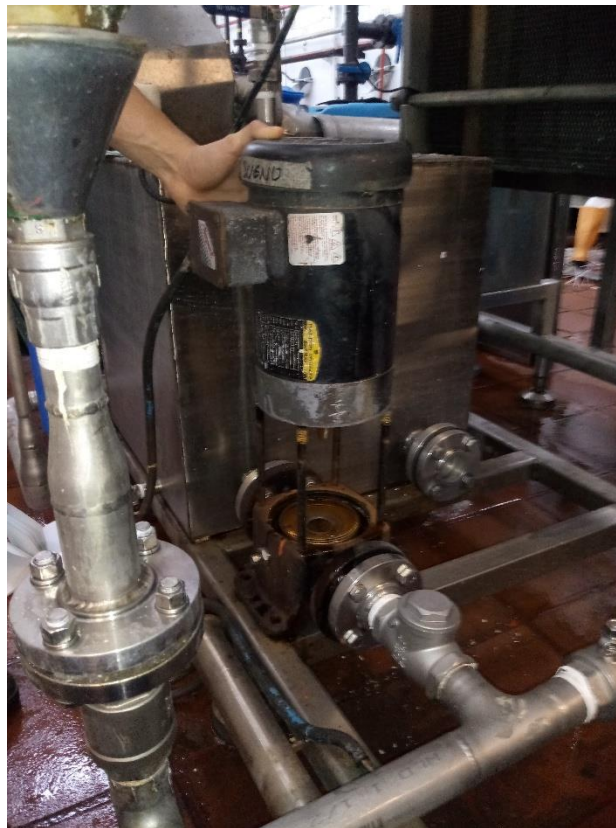
Figura 45. Mecanismo de bombeo del condensado del sistema I y lavadora de botellas (Fuente: autores)
