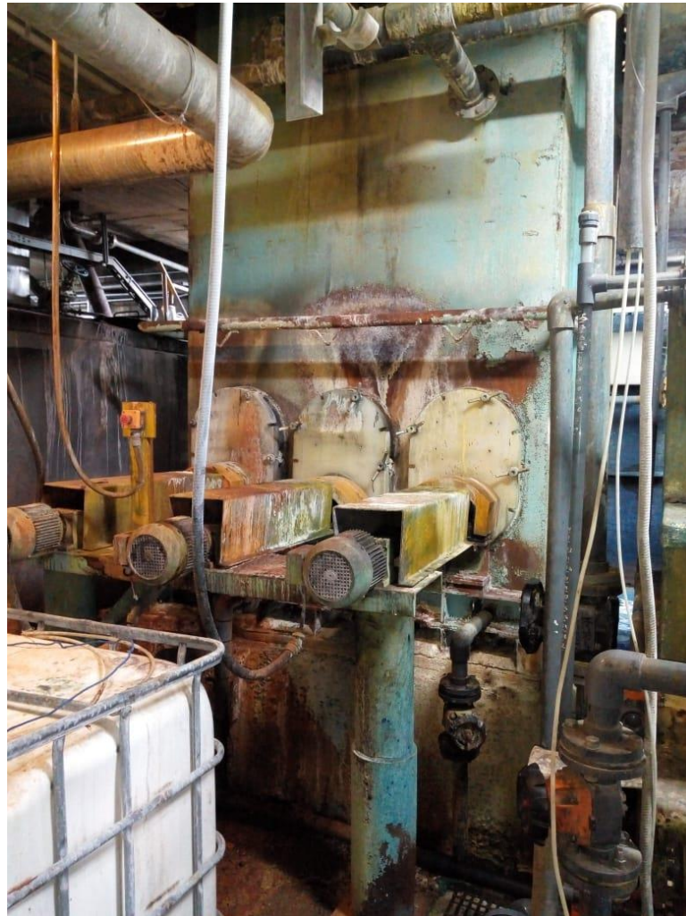
Ilustración 24. Tanque de Decapado
