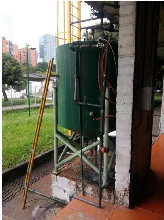
Ilustración 21: Tanque de alimentación calderas.
