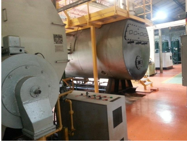
Ilustración 22: Cuarto de calderas.
