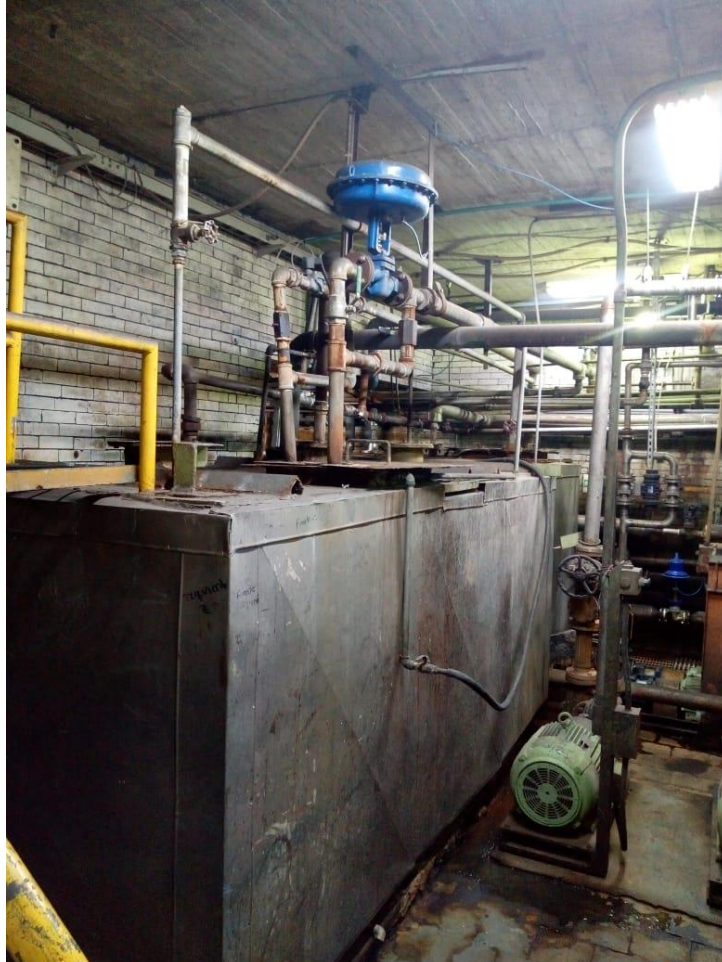
Ilustración 26. Tanque de Aguas Calientes
