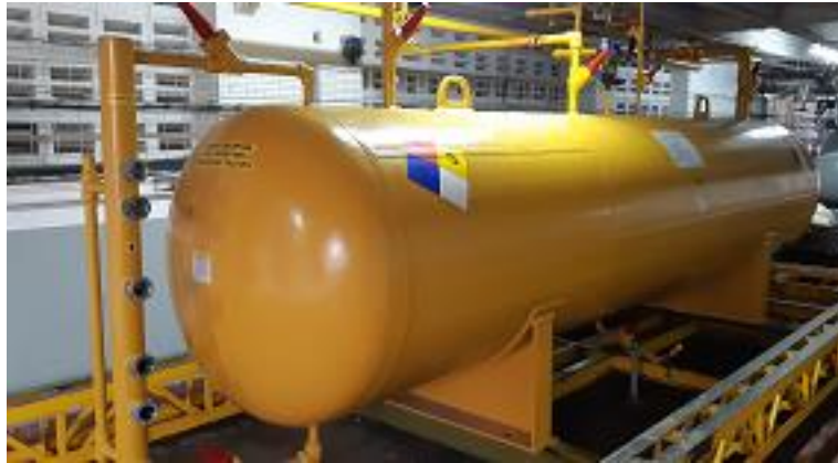
Figura 16. Tanque receptor de líquido a alta presión (Fuente propia)
