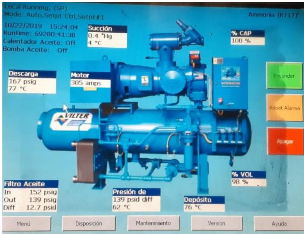
Figura 17. Pantalla del compresor Vilter (Fuente propia)
