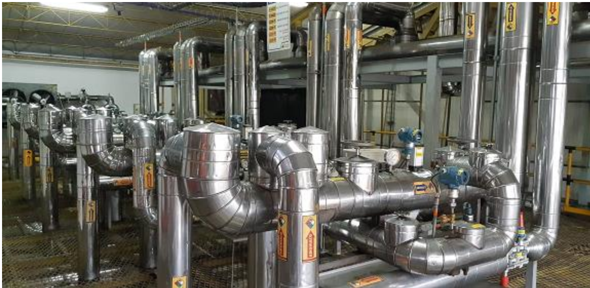
Figura 20. Juego de válvulas de los congeladores (Fuente propia)
