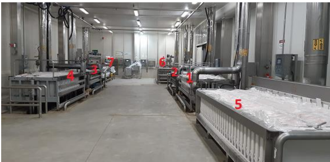
Figura 15. Sala de congelación (Fuente propia)
