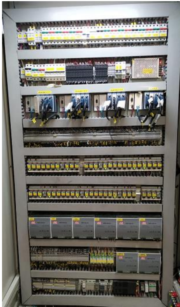
Figura 26. Tablero eléctrico y de control de los congeladores (Fuente propia)
