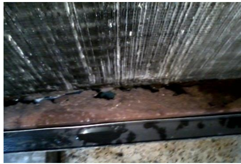
Figura N.4.2. 40. Piso de UMA totalmete oxidado.
