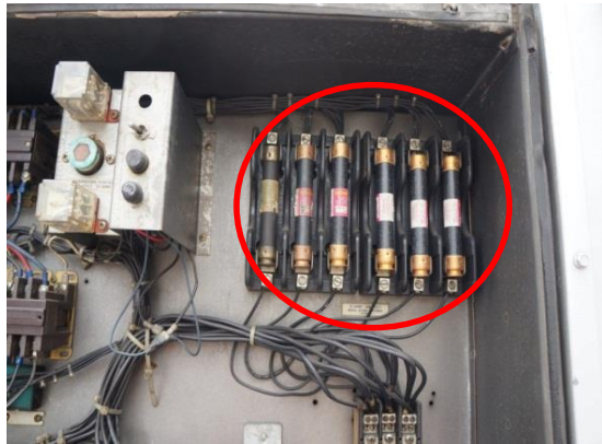
Figura N.4.2. 22. Caja de fusibles obsoleta y sin totalizador.
