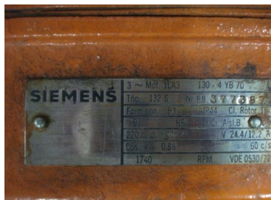
Figura N.4.2. 39. Placa de características motor UMA.
