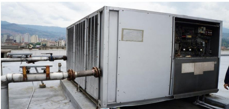
Figura N.4.1. 6. CHILLER Asamblea departamental.
