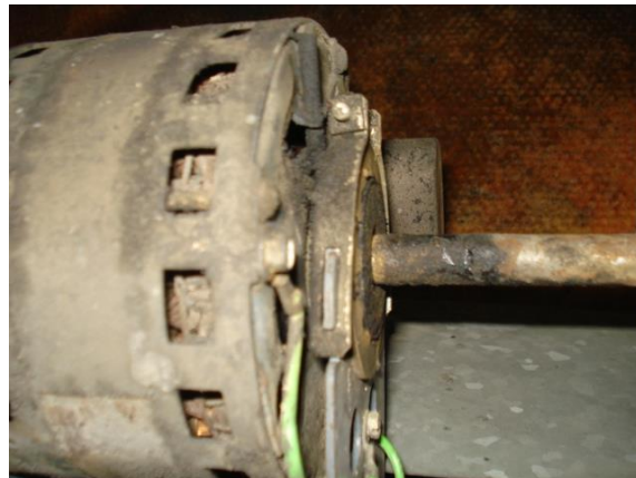
Figura N.4.2. 34. Motor electrico totalmente sucio y malo
