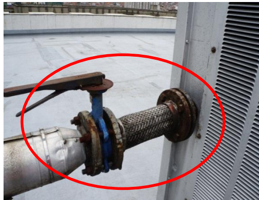
Figura N.4.2. 28. Acople antivibración oxidado.
