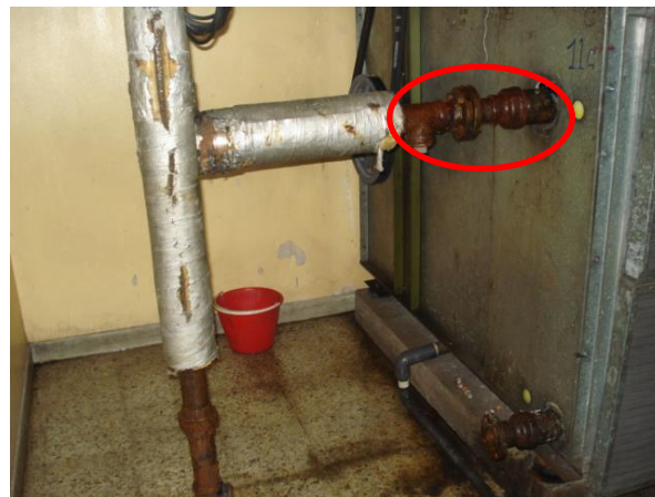
Figura N.4.2. 30. Tubería oxidada y sin aislamineto.
