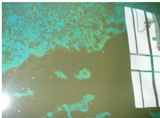
Figura N.4.2. 3.Material cedimentado Tanque torres de enfriamiento
