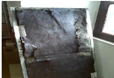
Figura N.4.2. 41. Filtro de aire para UMA totalmete sucio.
