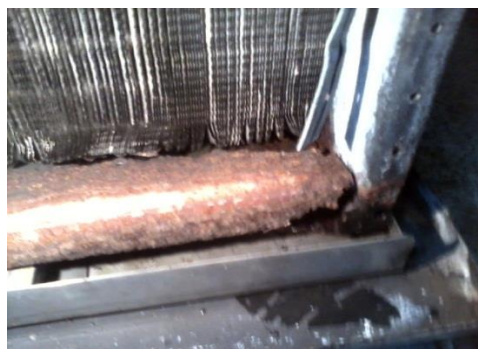
Figura N.4.2. 43. Evaporador UMA oxidado.
