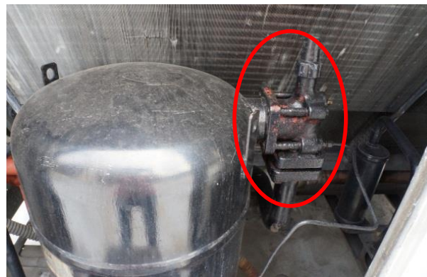
Figura N.4.2. 26. Portico de descarga oxidado.
