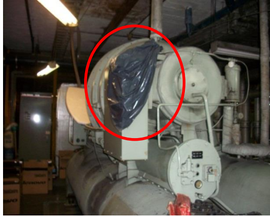
Figura N.4.2. 15.Solución a gotas de agua en el techo de casa de maquinas
