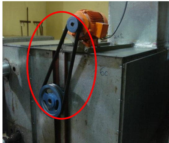
Figura N.4.2. 37. UMAS sin guarda en los motores
