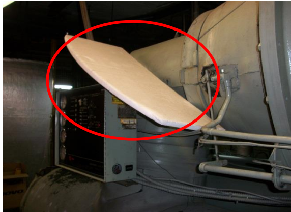
Figura N.4.2. 18. Protección contra gotas en el techo
