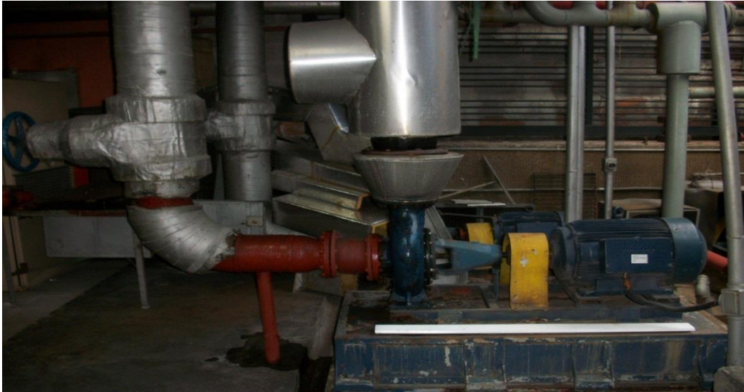
Figura N.4.1. 4. Bomba impulsora agua fría.
