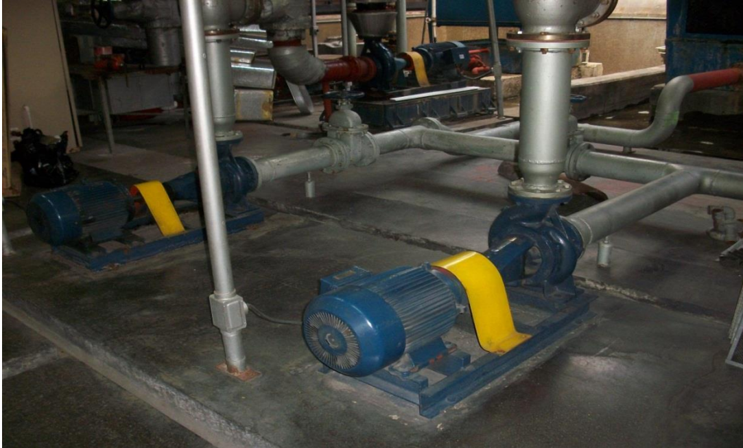
Figura N.4.1. 3. Sistema de bombeo torres de enfriamiento
