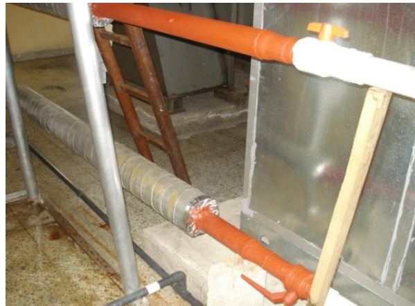
Figura N.4.2. 31. Tuberías sin aislamiento térmico y sin apoyo
