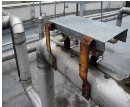
Figura N.4.2. 29. Sensores de temperatura para agua fria malos.
