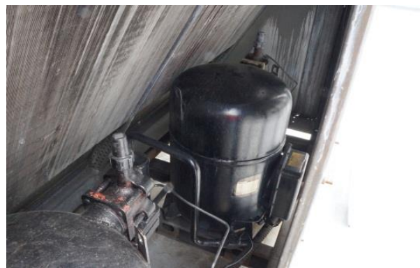
Figura N.4.2. 25. CHILLER Asamblea quemado debido a la falta de mantenimiento
