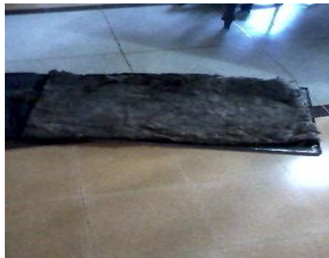
Figura N.4.2. 42. Filtro de aire para UMA totalmete sucio.
