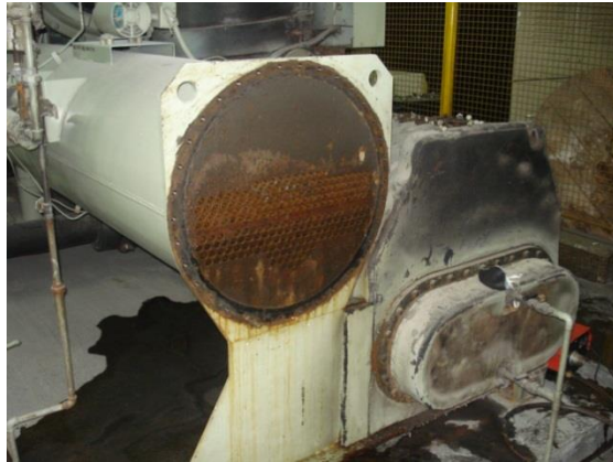
Figura N.4.2. 9. Lavado de Condensador CHILLER Gobernacion de Antioquia
