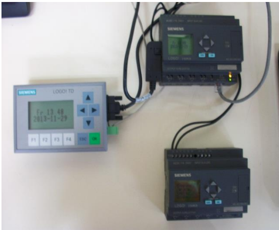
Figura N.4.4.3. 1. PLC maestro-esclavo y pantalla de control.
