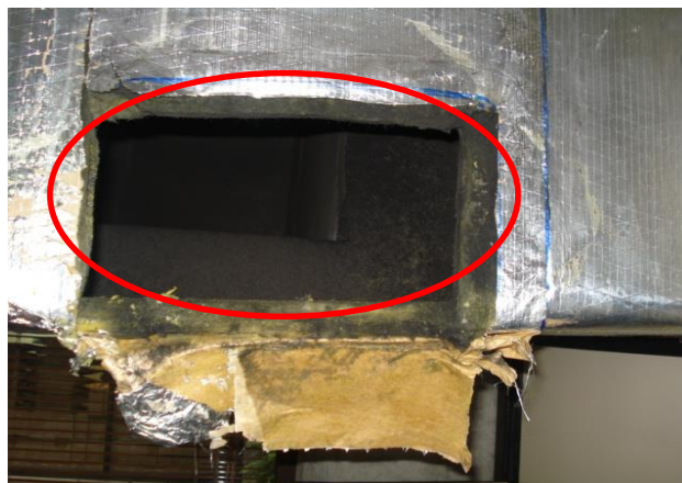
Figura N.4.2. 33. Ductos totalmente sucios.
