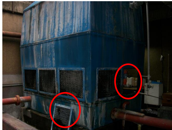
Figura N.4.2. 4.Torres de enfriamiento sin paneles
