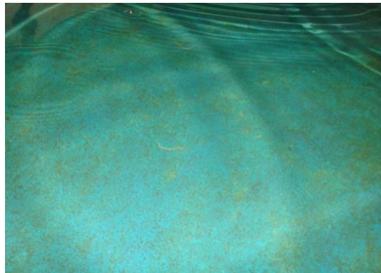
Figura N.4.2. 2.Tanque torre enfriamiento
