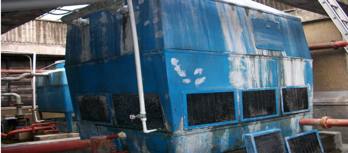
Figura N.4.1. 2. Torres de enfriamiento CHILLER Gobernación de Antioquia
