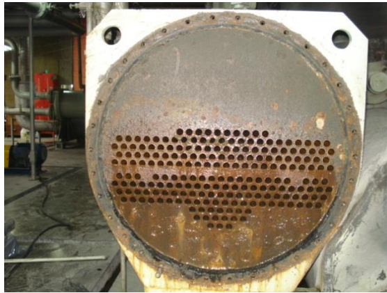
Figura N.4.2. 10. Condensador CHILLER incrustado
