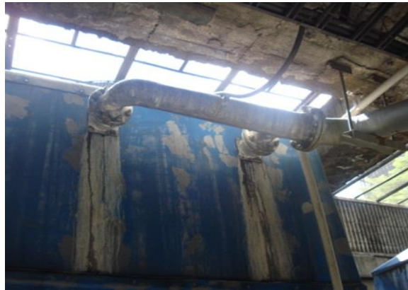
Figura N.4.2. 8. Fugas entrada de agua caliente torres de enfriamiento
