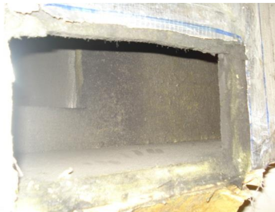
Figura N.4.2. 32. Ductos totalmente sucios.
