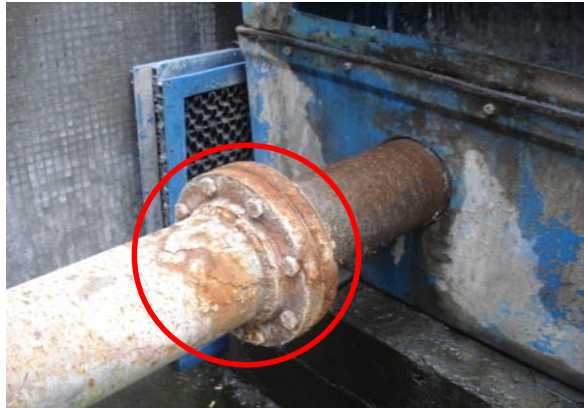
Figura N.4.2. 7. Brida de torre oxidada.
