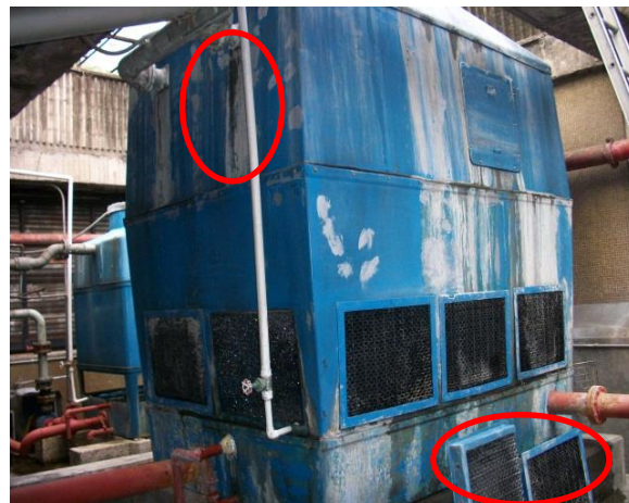
Figura N.4.2. 5.torre de enfriamiento con fugas en la entrada del agua
