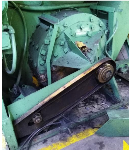
Figura 19. Ventilador de extracción
