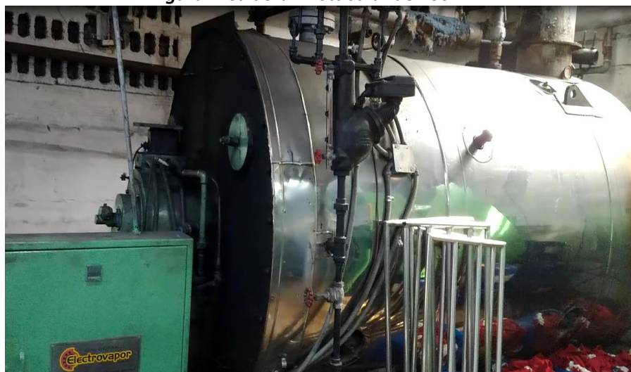
Figura 2. Caldera Piro-tubular de 100 BHP
