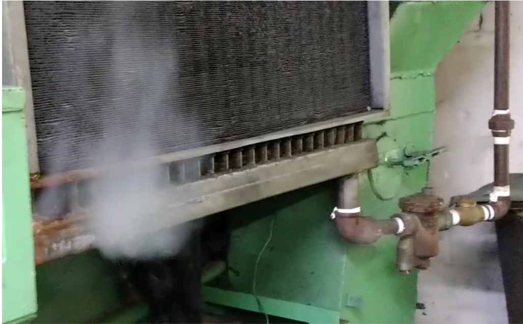
Figura 3. Intercambiador de calor con fuga de vapor y corrosión
