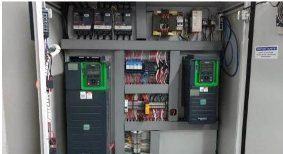
Figura 42. Gabinete eléctrico ensamblado. Fuente: Elaboración propia.
