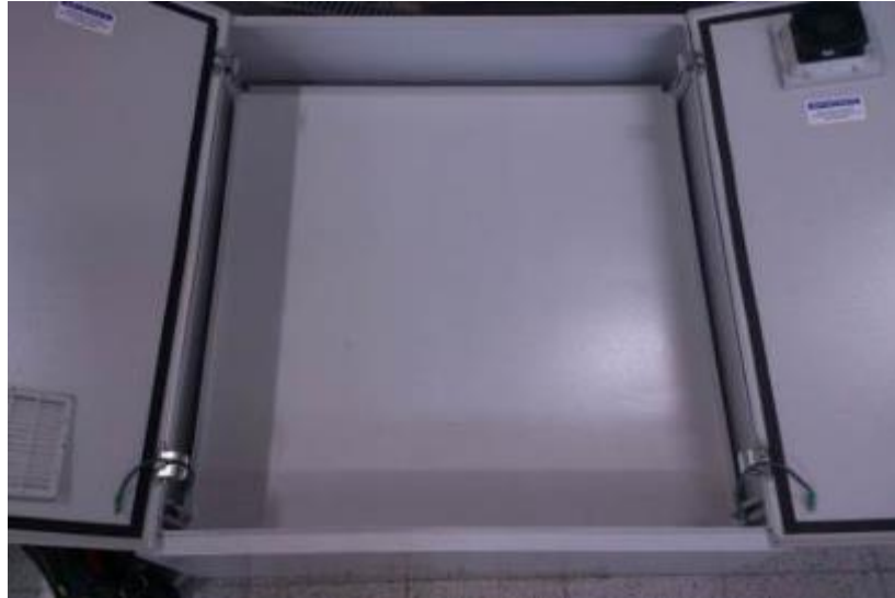
Figura 39. Gabinete eléctrico. Fuente: Elaboración propia
