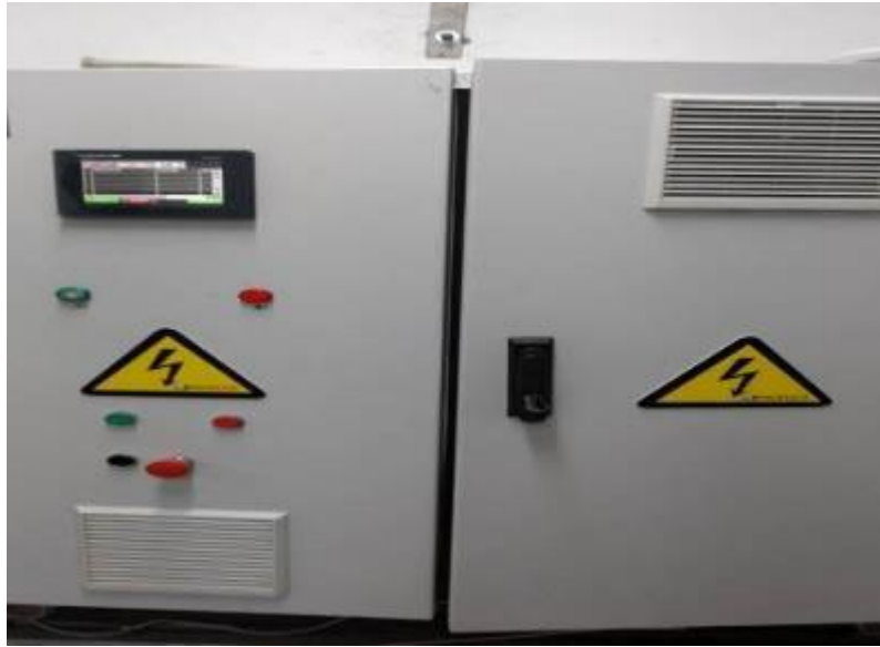
Figura 43. Gabinete parte externa. Fuente: Elaboración propia.
