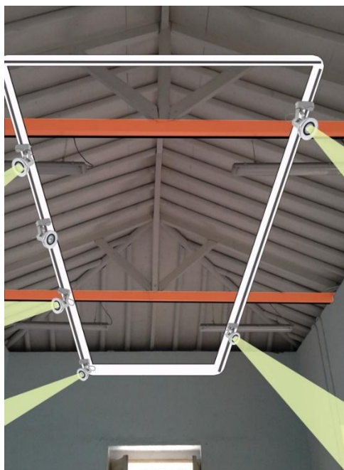
Figura 30. Sistema de rieles con proyectores, anclado a las dos soleras inferiores de los tímpanos.
