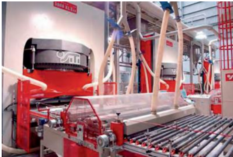
Ilustración 12 Prensa hidráulica para el conformado de baldosas cerámicas (Fuente: Monfort, 2011)
