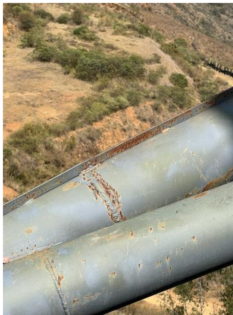
Figura 1. Corrosión atmosférica de piezas metálicas expuestas en un ambiente urbano, escultura dentro del parque nacional Chicamocha, Colombia (fotografía propia).
