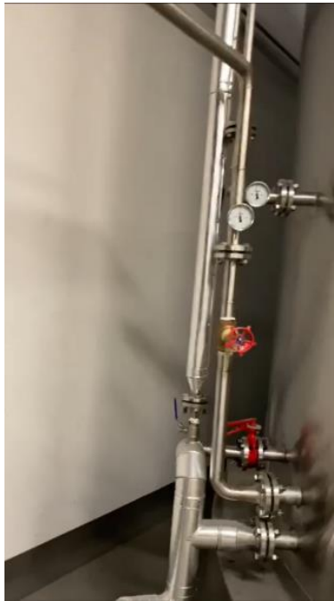
Imagen 26. Muestra las Válvulas instaladas para el ingreso de la grasa al tanque. (Fuente: Elaboración propia).
