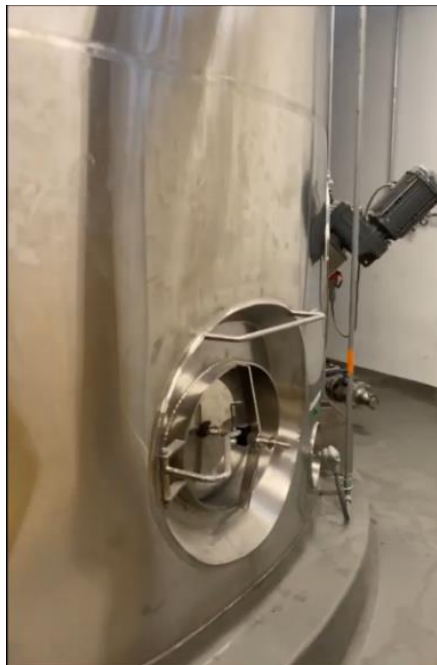
Imagen 27. Muestra el Motor agitador instalado. (Fuente: Elaboración propia).
