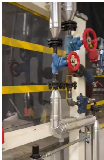
Imagen 11. Conexiones de válvulas y tuberías en el sistema de recepción. (Fuente: Elaboración propia).
