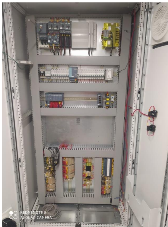
Imagen 6. Ensamblaje del tablero de potencia y control. (Fuente: Elaboración propia).
