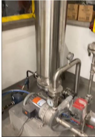
Imagen 10. Bomba de transferencia instalada en el sistema. (Fuente: Elaboración propia).
