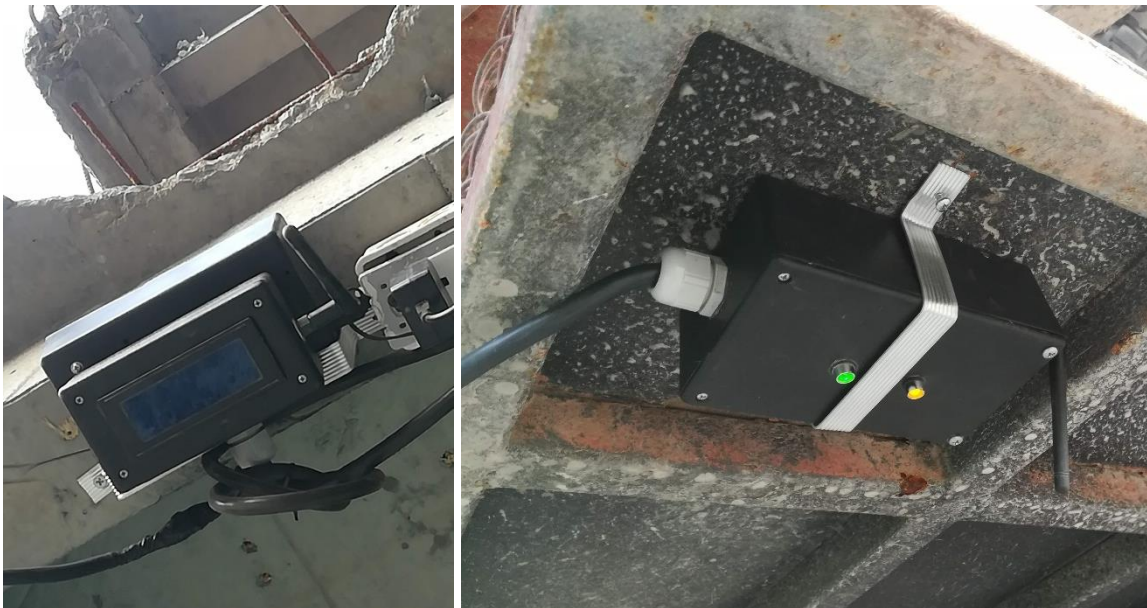
Figura 29: montaje de emisor y receptor. A la izquierda, receptor anclado en viga, a la derecha, emisor instalado en cabina de malacate. (Propia)
