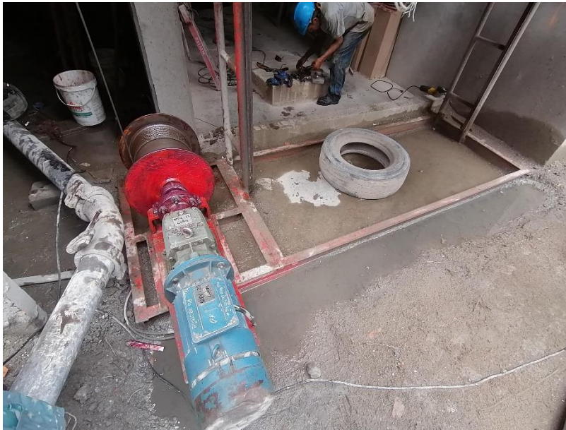
Figura 14: sistema electromecánico del malacate. Motor, caja reductora, winche. (Propia)
