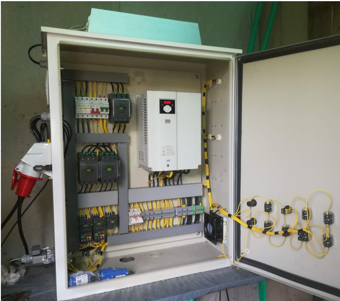
Figura 23: tablero de control implementado para el sistema de control según esquema eléctrico.
