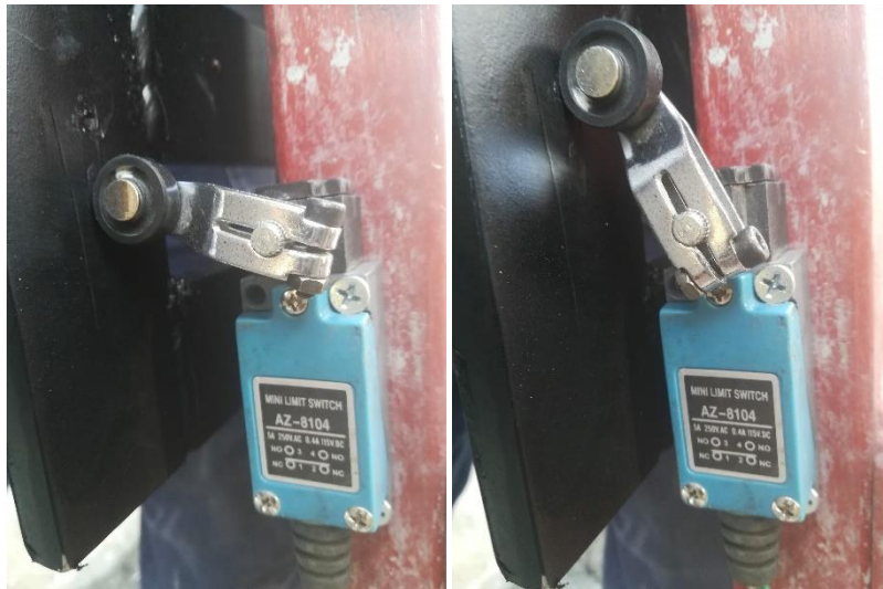
Figura 29: interruptor de estado de puerta. (Propia)
