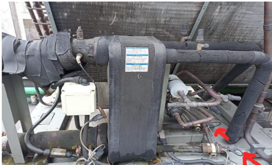
Figura 11. Válvula de expansión del sistema de refrigeración. Fuente: autor
