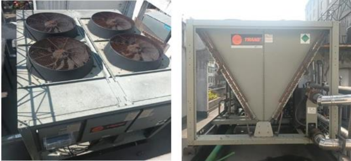
Figura 5. Vista superior (izquierda) y lateral (derecha) del chiller Trane. Fuente: autor
