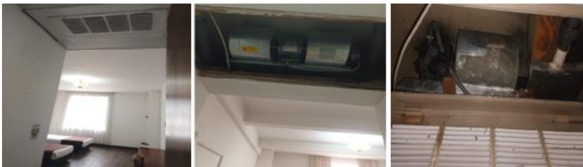
Figura 22. Fancoil en habitaciones. Fuente: autor
