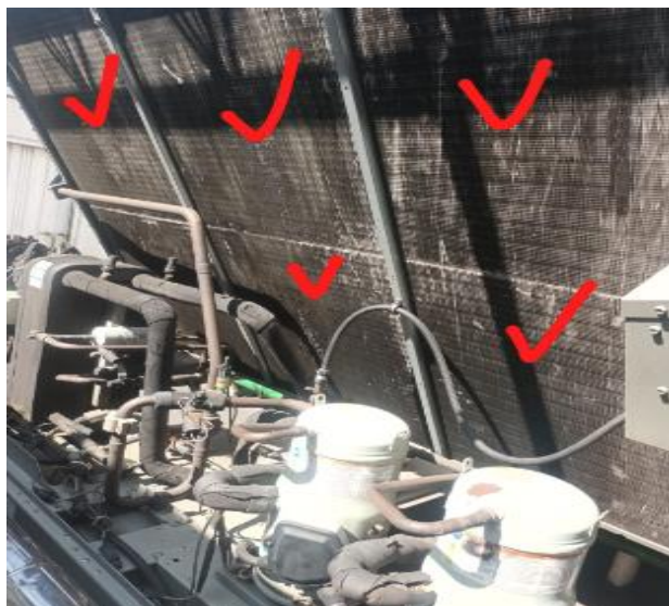
Figura 26. Serpentín incrustado. Fuente autor
