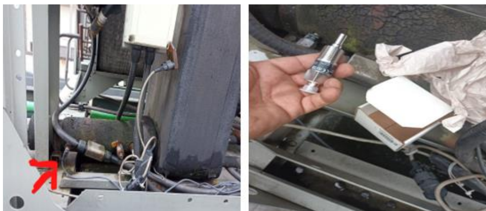
Figura 18. Sensores traductores de flujo de agua. Fuente: autor
