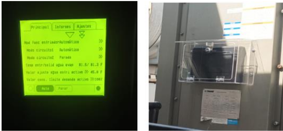
Figura 13. Periférico Navigator Trane Fuente: autor
