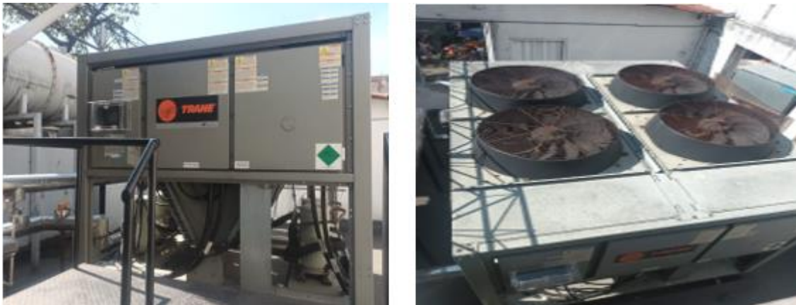
Figura 1. Chiller Trane Hotel Nutibara Medellín.
