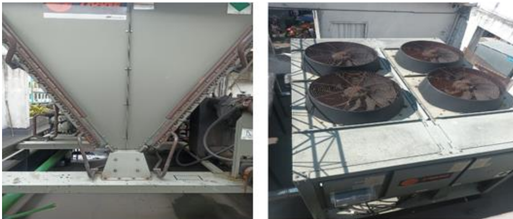
Figura 10. Condensadores del chiller marca Trane. Fuente autor
