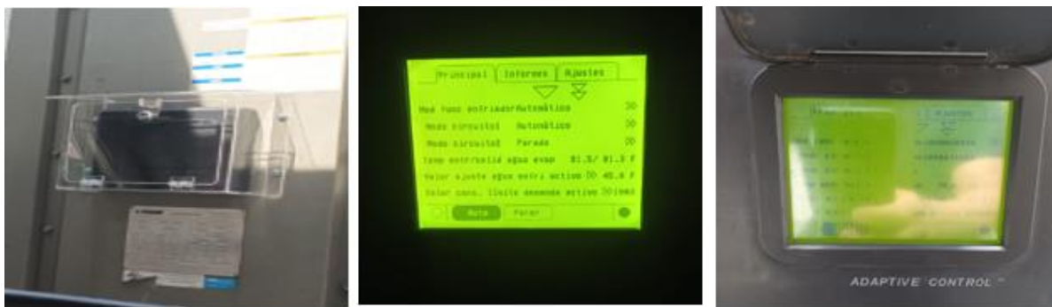
Figura 7. Interfaz para hacer control del equipo Trane. Fuente: autor
