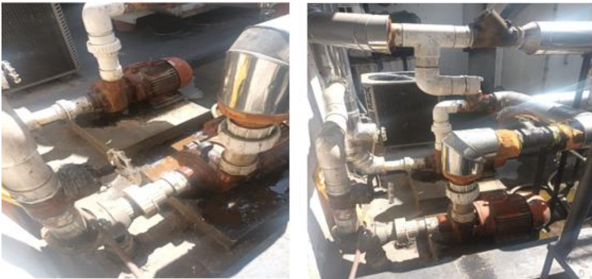
Figura 14. Bomba de agua principal (izquierda), bomba de agua reserva (derecha).
