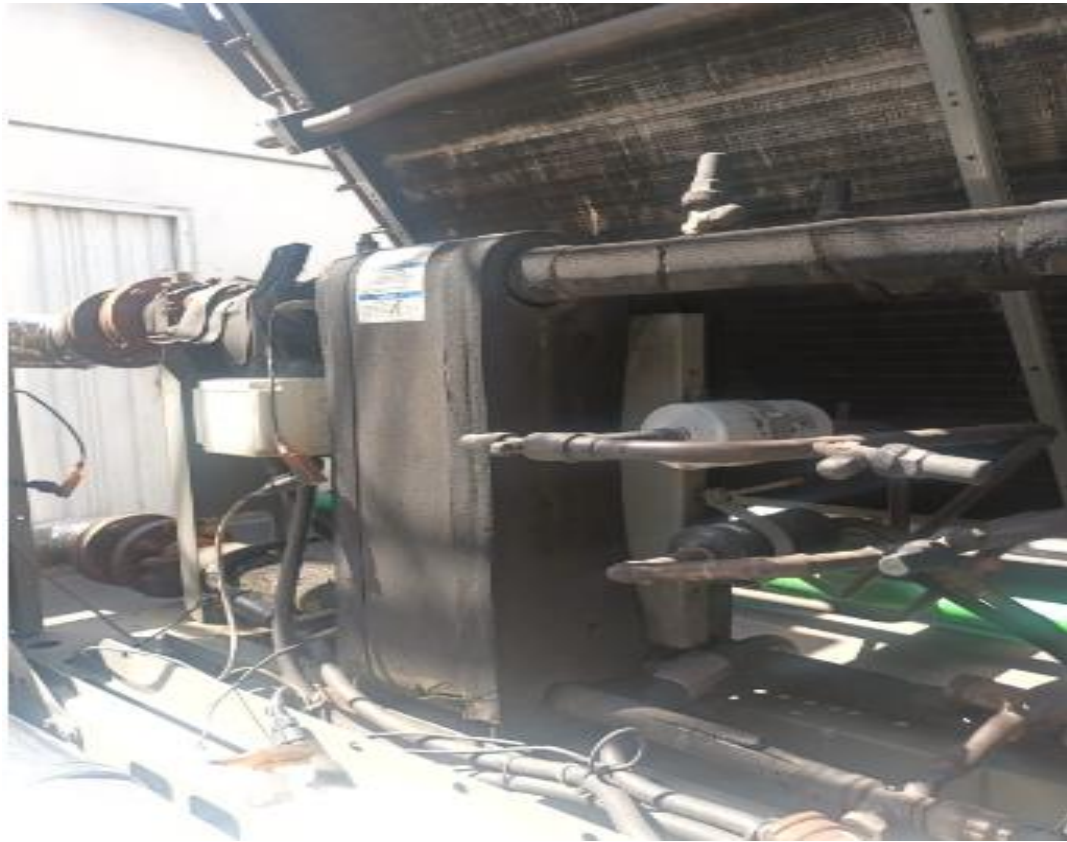
Figura 12. Intercambiador de calor del sistema. Entrada y salida de agua y entrada de refrigerante. Fuente: autor
