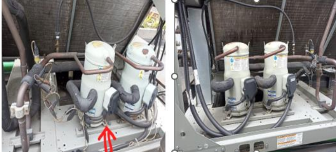
Figura 9. Compresores del chiller Trane del hotel Nutibara. Fuente: autor.
