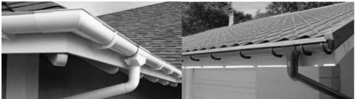
Figura 21. Captación de Agua Lluvia. (Cure & Gómez, 2020)
