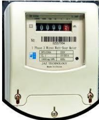
Figura 8. Medidor monofásico bifilar jaz shenzhen (9)
