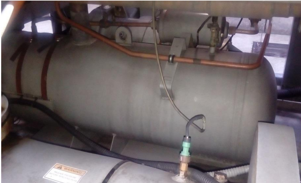
Figura 6. Separador de Aceite, ubicado en la fase de descarga del compresor.
