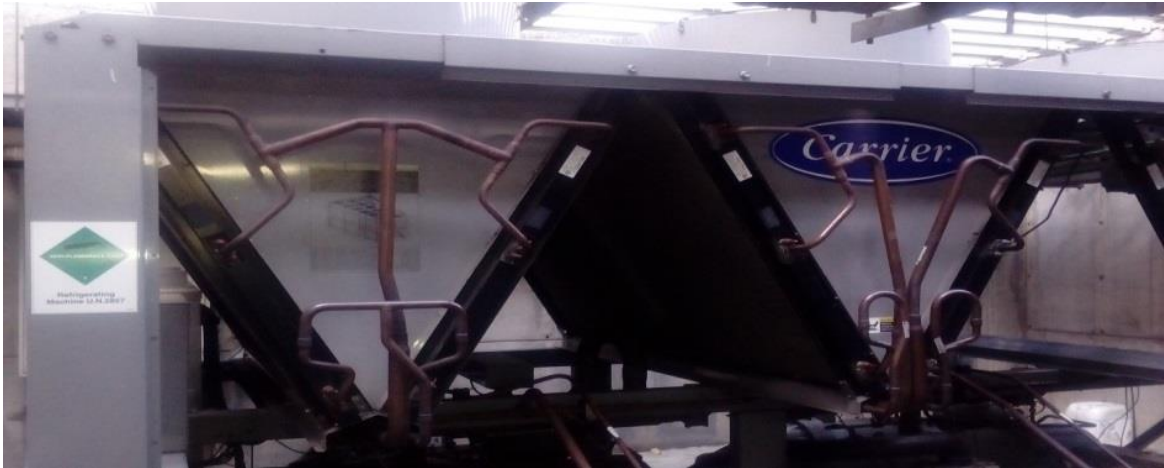
Figura 7. Condensadores del Chiller Marca Carrier.
