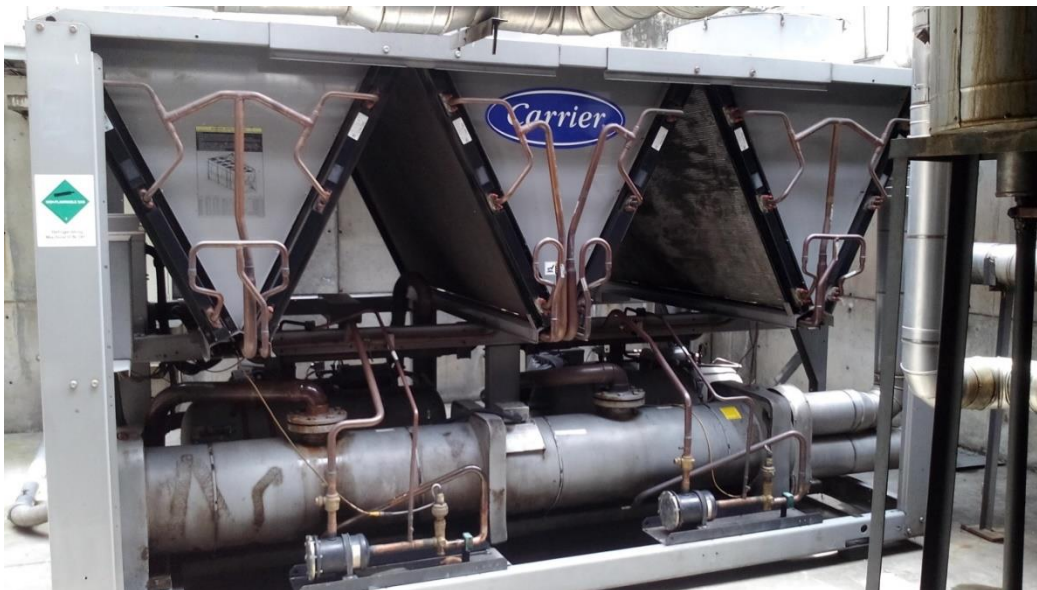
Figura 1. Chiller de 80 TR marca Carrier, del área de Urgencias Pediátricas del Hospital San Vicente Fundación.
