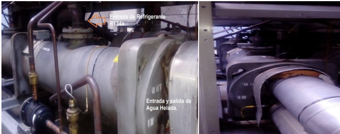
Figura 9. Evaporador del sistema. Entrada-salida de agua y entrada de refrigerante.
