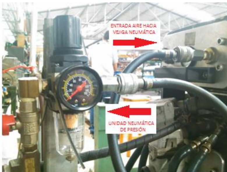
Figura 103. Instalación neumática para generar presión al proceso de vulcanizado.
