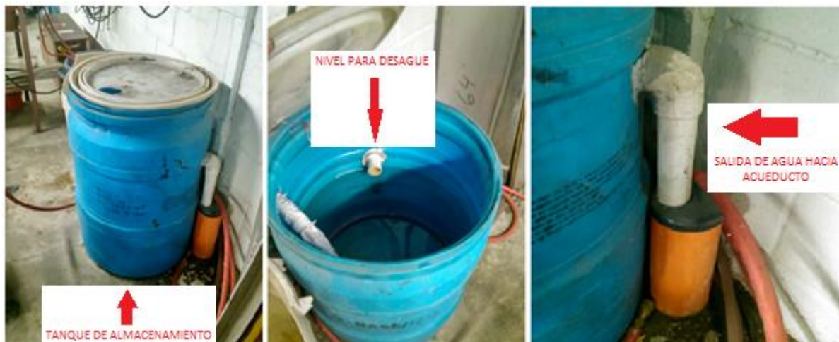
Figura 102. Tanque de almacenamiento del agua.
