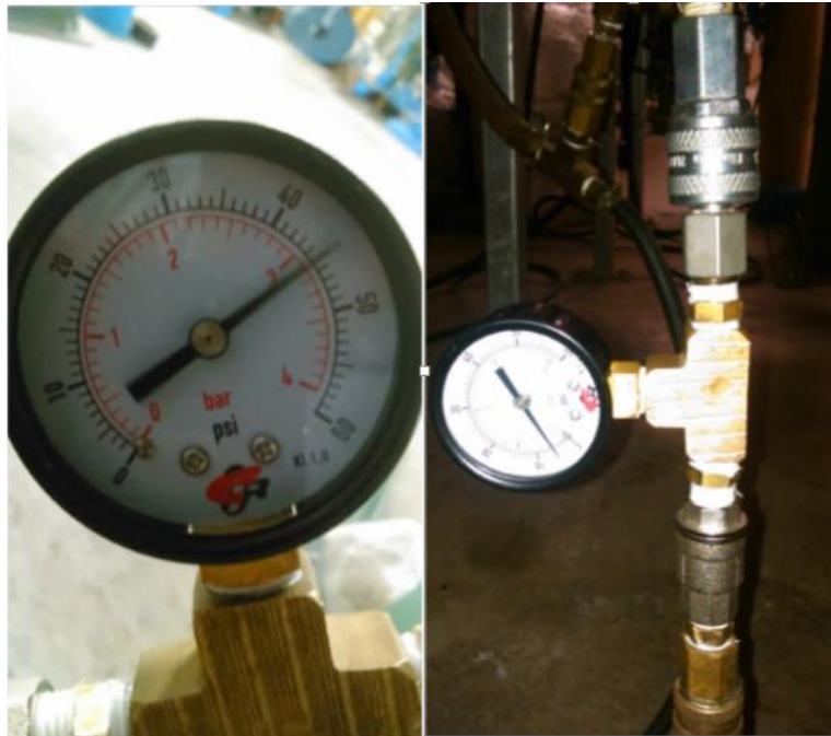
Figura 107. Medición de presiones del agua a la entrada y salida de la vulcanizadora.
