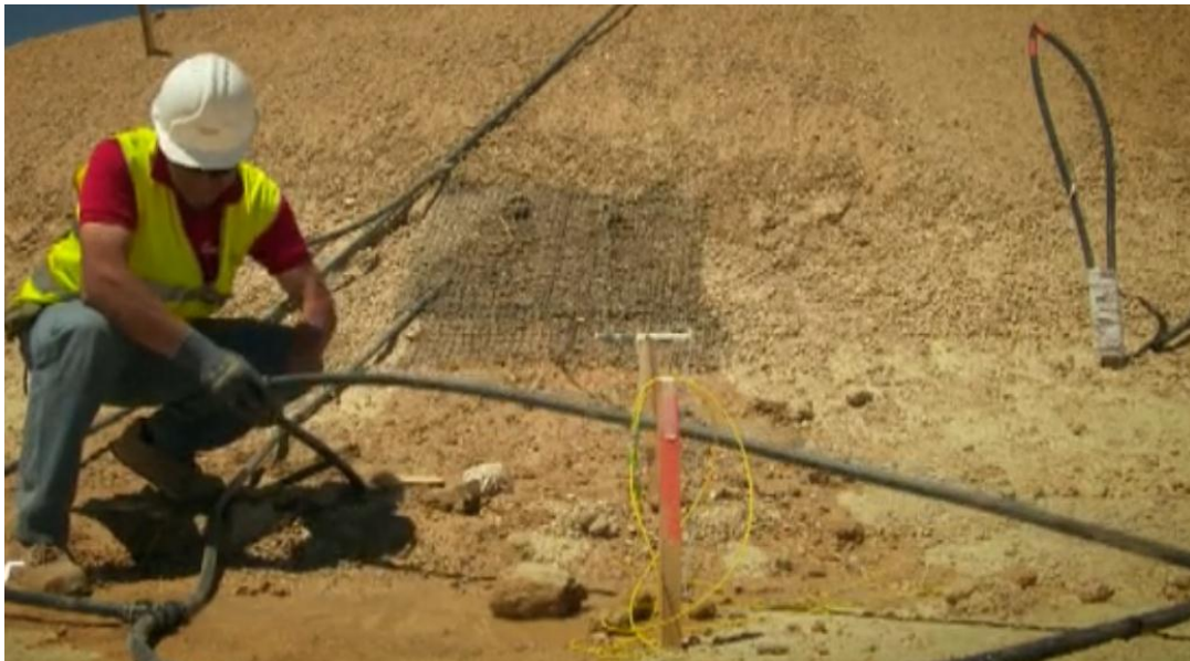
Figura 1. Sensores de fibra óptica en mallas para predecir deslizamientos de tierra.
