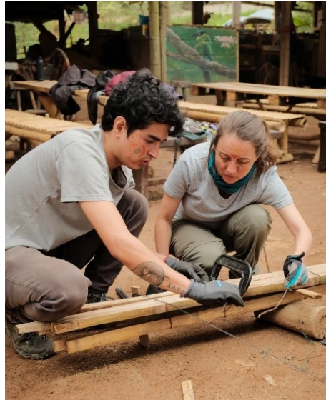
Nota. Proceso de construcción de arco con guadua, utilizando la técnica de viga lata. Fotografía de @almapachamama.
