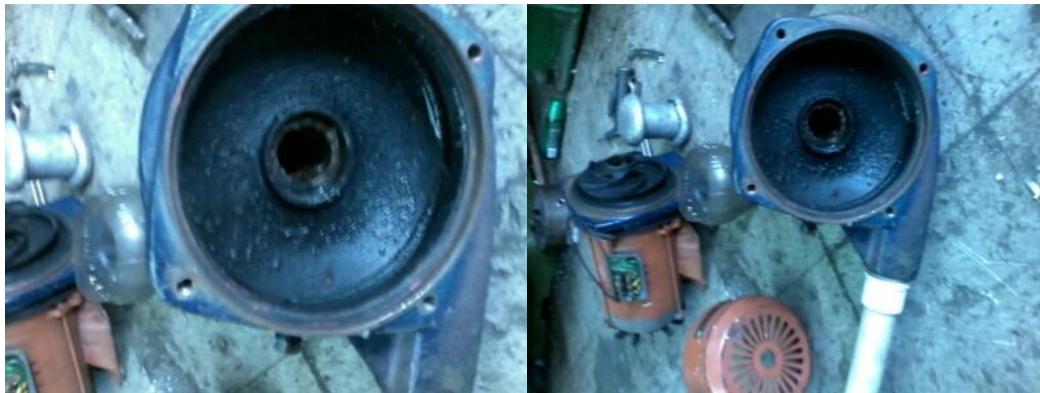
Figura 25. Caracol bomba centrifuga trifásica.
