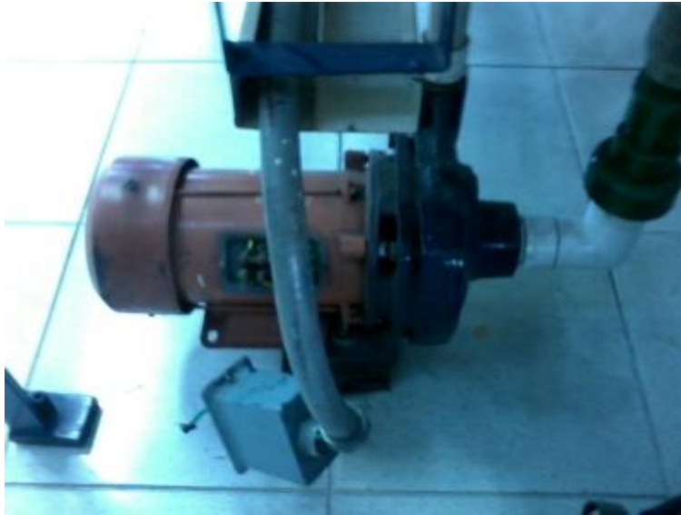
Figura 22. Bomba trifásica. Fuente: elaboración propia
