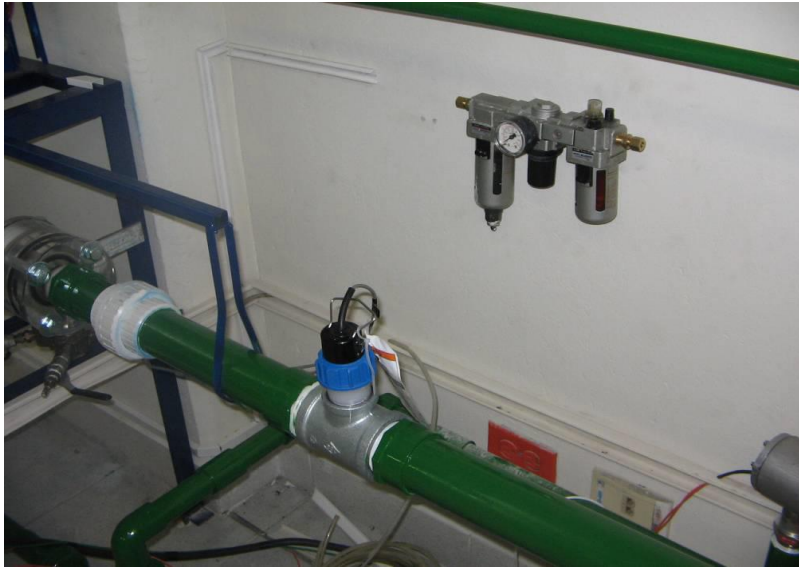
Figura 16. Sensor de rotor en tubería. Fuente: elaboración propia
