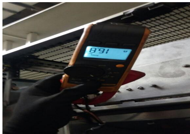
Figura 45. Amperaje en la línea de alimentación del sistema de ventilación. Fuente: Propia.
