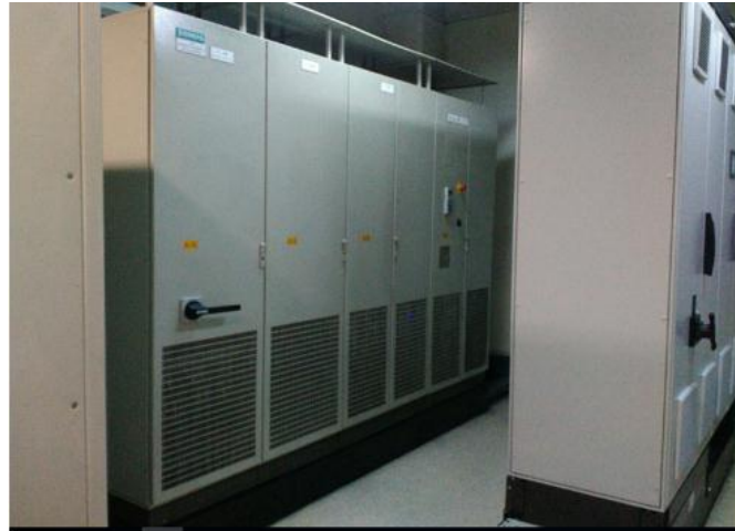
Figura 17. Gabinetes de cada ventilador del sistema de extracción. Fuente: propia.
