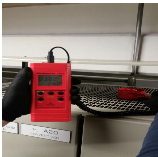
Figura 43. Velocidad y temperatura del aire extraído
