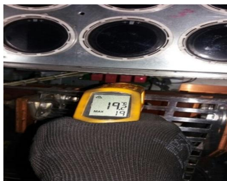
Figura 41. Temperatura de la tarjeta con el sistema de ventilación
