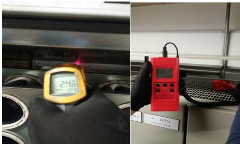
Figura 16. Mediciones realizadas al sistema de ventilación forzada Fuente: Propia.
