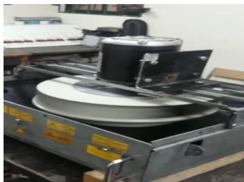
Figura 37 . Verificación visual del sistema en funcionamiento. Fuente: Propia.
