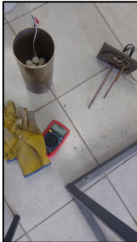
Figura 25. Tubo del recuperador de calor
