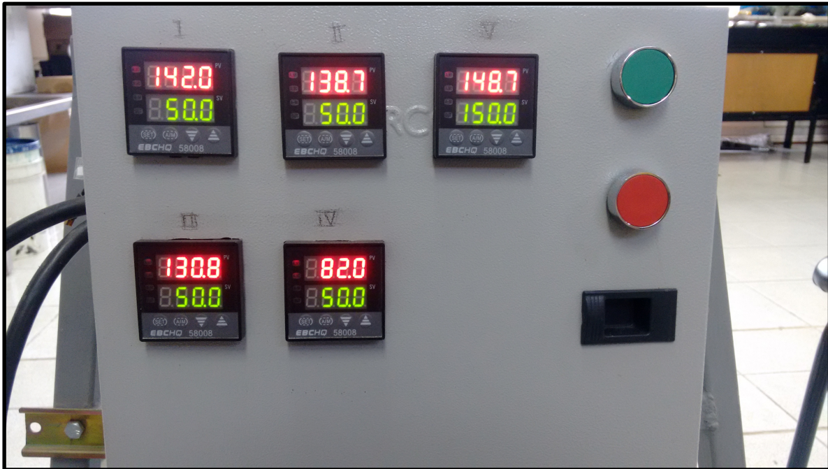
Figura 26. Paneles de control. Fuente: Autor
