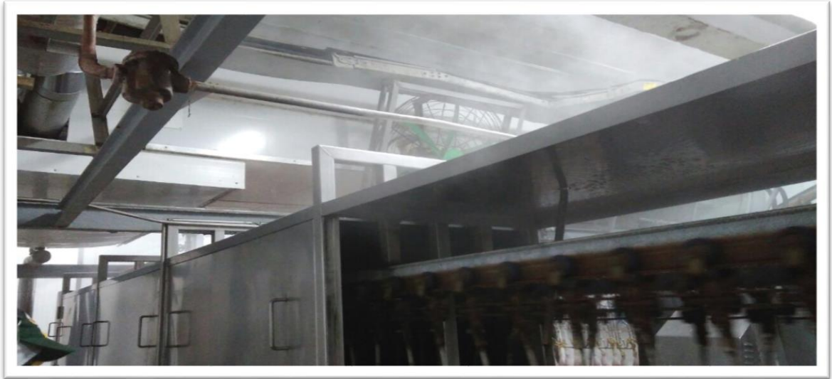
Figura 25. Recuperación de condensación a tanque de agua caliente. Tomada por los autores.
