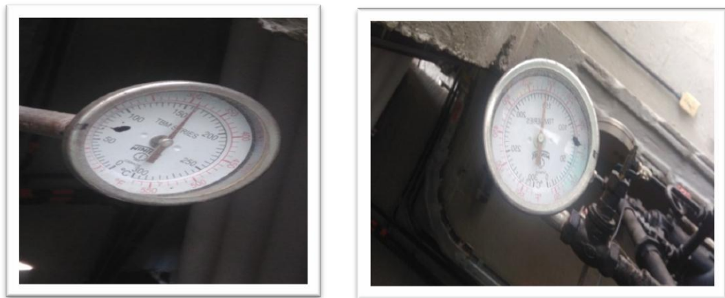
Figura 18. Temperatura tomada a la salida de la caldera. Fotografía tomada por los autores.
