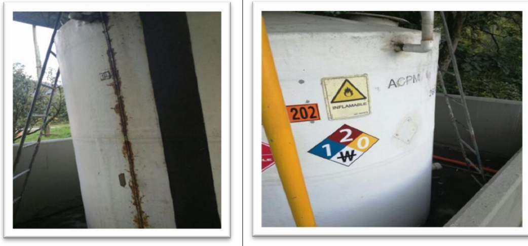
Figura 19. Consumo tomado en medidor de ACPM. Fotografía tomada por los autores.
