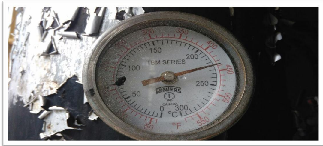
Figura 14. Dato de Temperatura Chimenea. Fotografía tomada por los autores.
