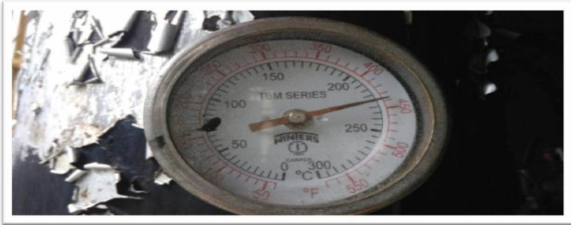
Figura 24. Temperatura salida de los gases. Tomada por los autores.
