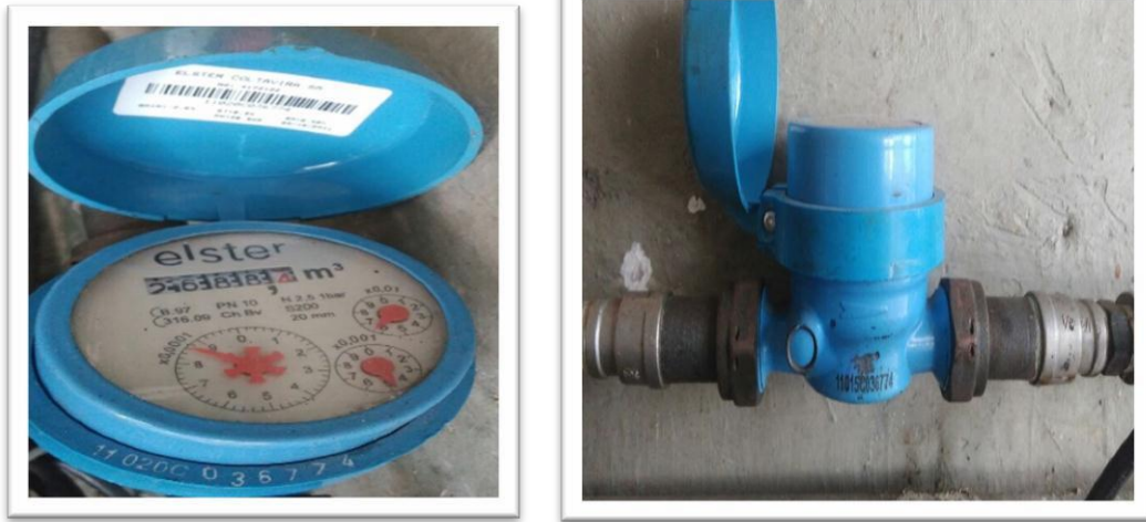
Figura 12. Dato de Caudal. Fotografía tomada por los autores.
