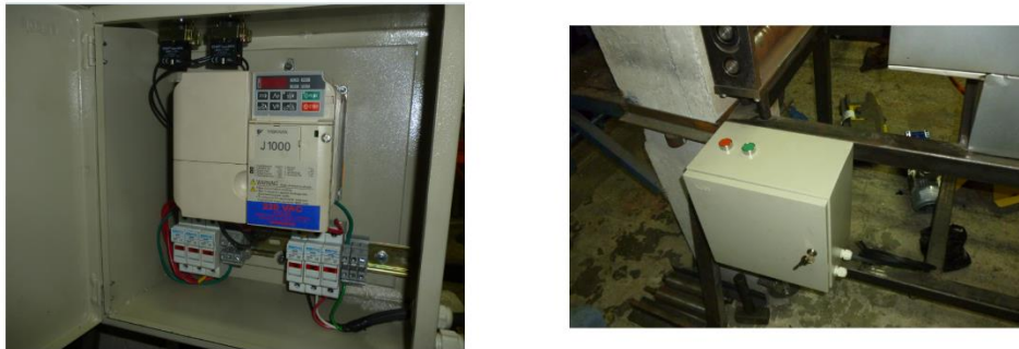
Figura 52. Fotografías sistema controlador Variador Yaskawa (Fuente: Autor).
