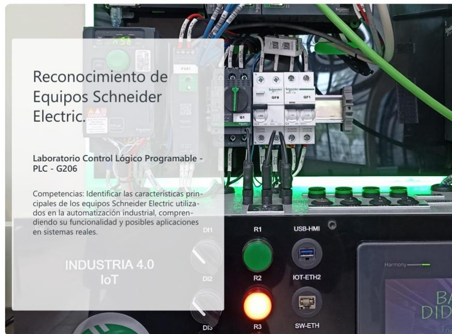
Figura 6. Encabezado Guía de Reconocimiento de Equipos Schneider Electric. Elaboración propia.
