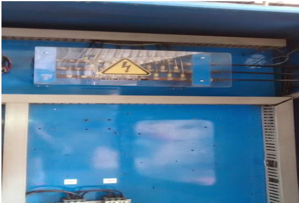
Figura 19. Tablero de la caldera JCT. Fuente propia tomada en Solla S.A.
