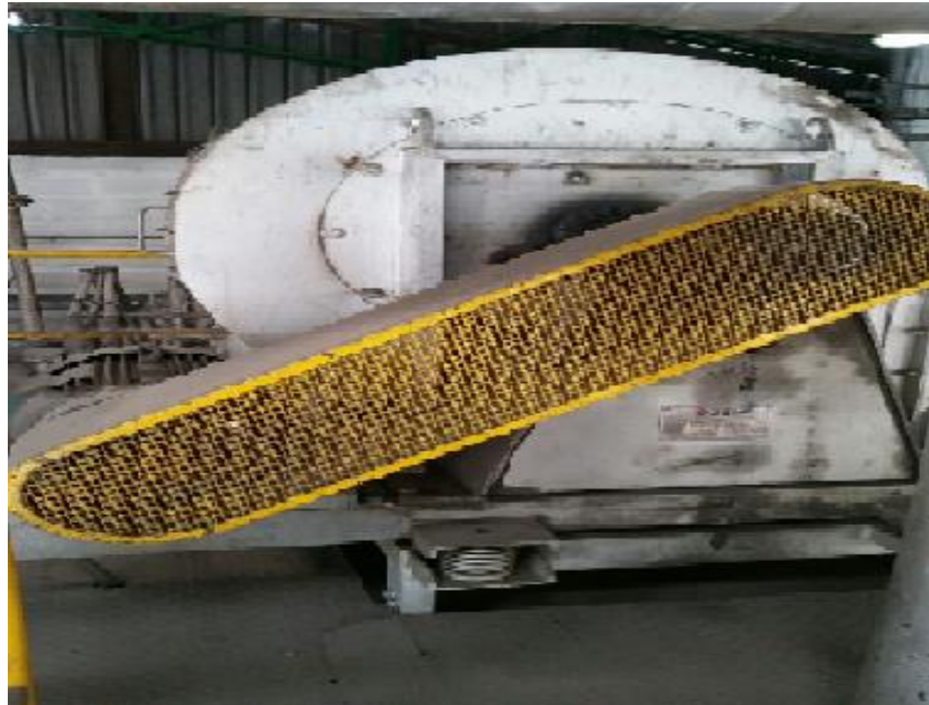
Figura 12. Ventilador tiro inducido. Fuente: Propia Tomada en planta de Solla Bello.
