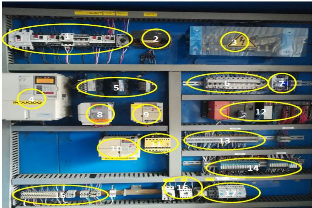
Figura 21. Tablero de caldera con PLC. Fuente: propia tomada en Solla S.A.
