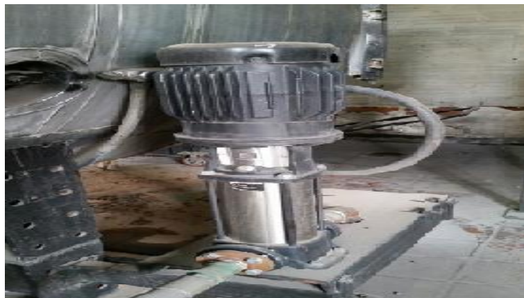
Figura 14. Bomba de alimentación de agua. Fuente: Propia tomada en planta de Solla Bello.
