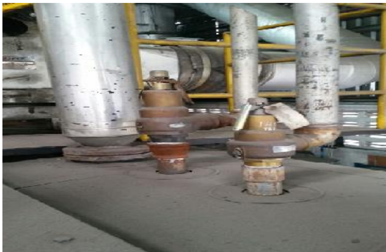
Figura 15. Válvulas de seguridad de la caldera. Fuente: Propia tomada en planta de Solla Bello.
