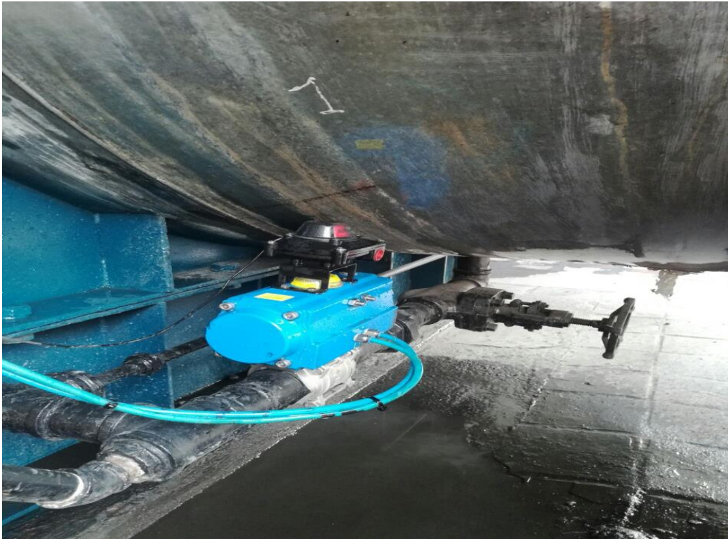
Figura 22: Válvula de purga con actuador electro neumático. Fuente: propia tomada en Solla S.A.
