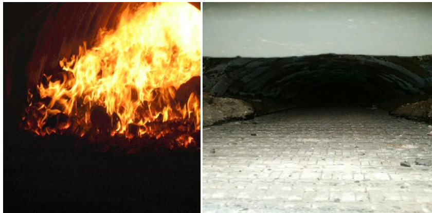
Figura 9. Hogar de combustión de la caldera a carbón. Fuente: Calderas JCT, 2012.
