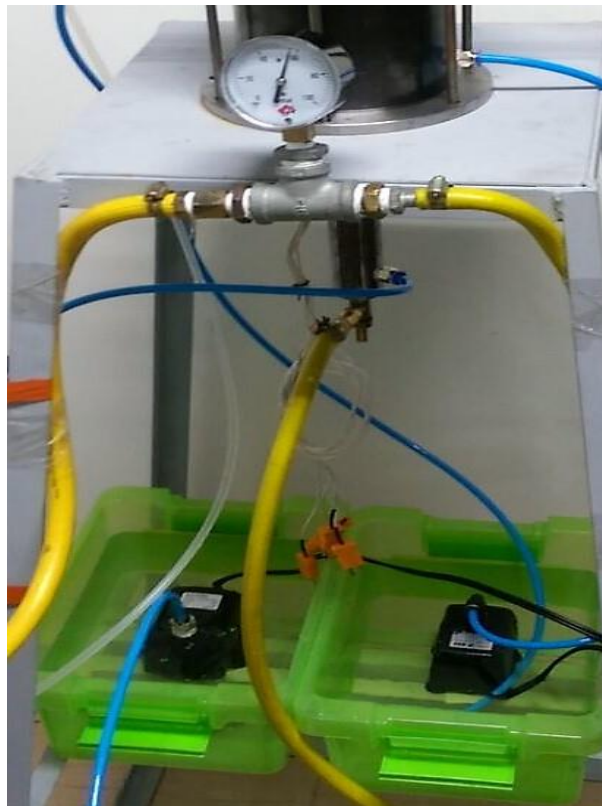
Ilustración 23. Conexión del suministro de gas al inyector.
