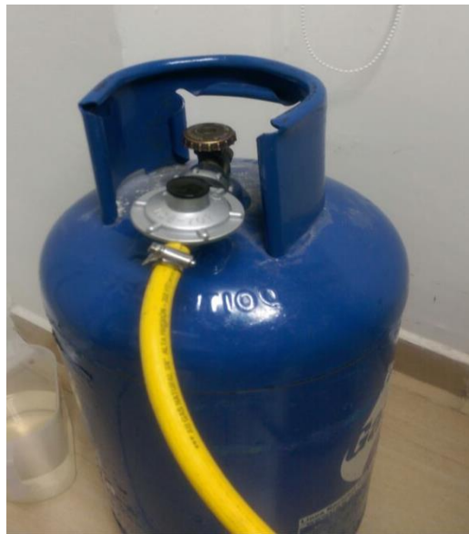
Ilustración 21. Cilindro de GLP, sistema de regulación y manguera de suministro
