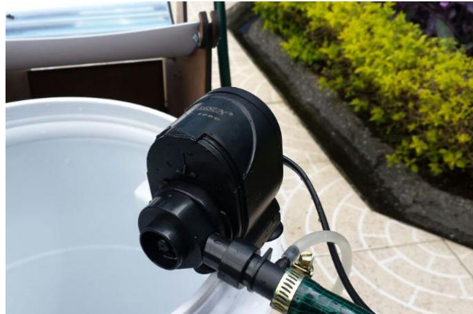
Imagen 8. Bomba acoplada. Fuente propia.
